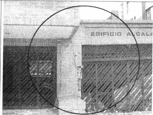
Foto 4. Asentamiento diferencial evidente en los dos sectores de la construcción.
