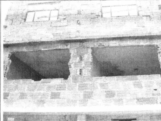
Foto 2. Parte superior de la fachada. Falta de ventanas y cubierta.
