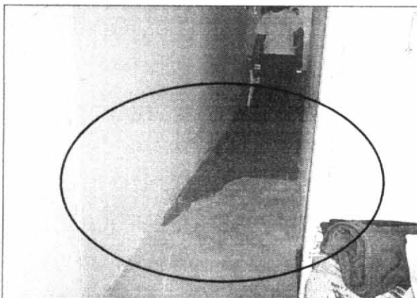
Foto 3. A nivel de piso dos (2) se evidenció que la placa de entrepiso ha sido reparada superficialmente debido a fisuras y agrietamientos presentadas en la misma.
