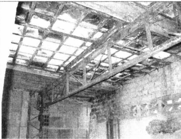
Foto 7. Deflexiones del entrepiso.
