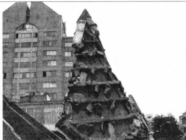
Foto 15. Pináculo de cubierta inestable con posibilidades de colapso.
