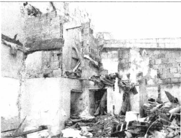
Foto 9. Muros del sector oriental con posibilidades de colapso, ver concepto No. CAR-209.
