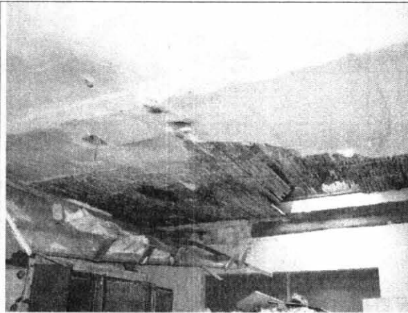
Foto 5. Colapsos parciales del cielo raso.
