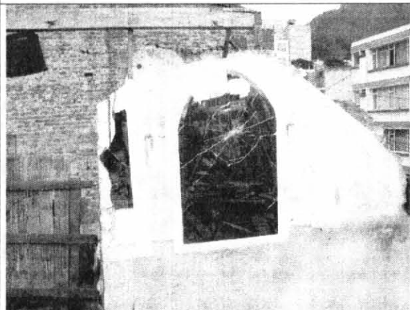
Foto 13. Muro de altillo con posibilidades de colapso.
