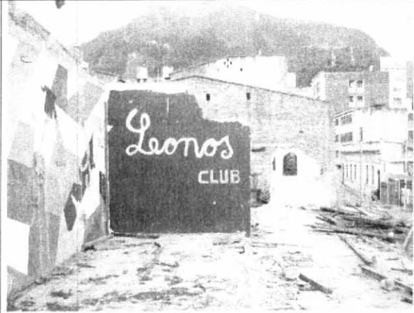
Foto 12. Muro de altillo suelto e inestable.
