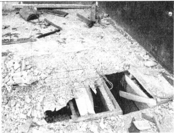
Foto 8. Daño de la placa del entrepiso.
