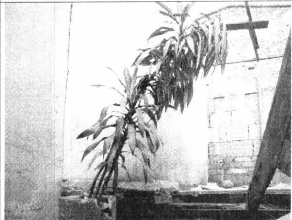
Foto 14. Muro de altillo suelto e inestable.
