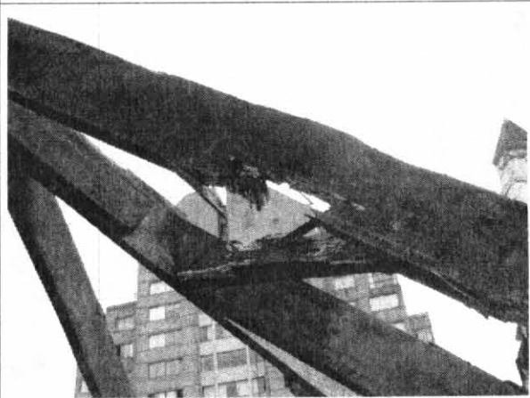
Foto 12. Elementos de madera pertenecientes a la estructura de cubierta con alto deterioro.
