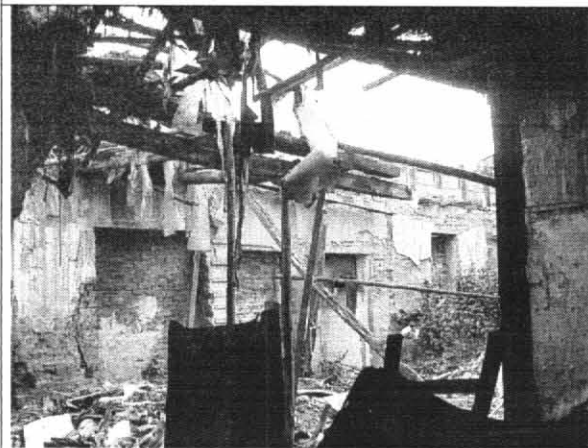
Foto 3. Estructura parcialmente colapsada al interior del inmueble.
