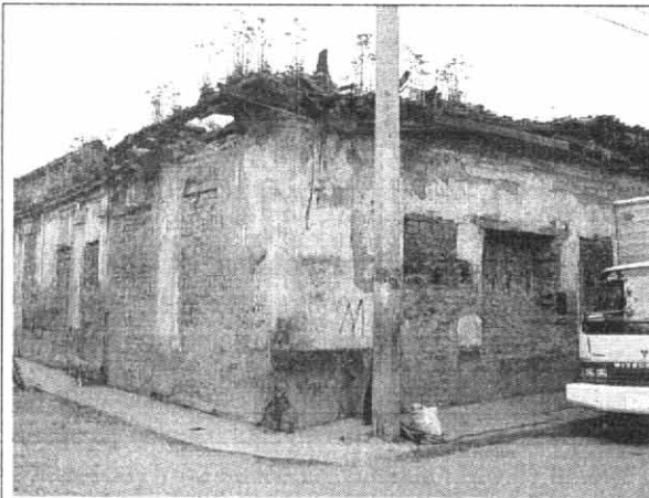
Foto 1. Condiciones de fachada al momento de la visita. Desprendimiento de acabados y deterioro progresivo.
