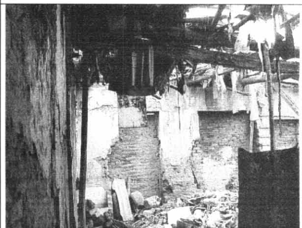
Foto 4. No hay ningún tipo de amarre que garantice integralidad estructural.
