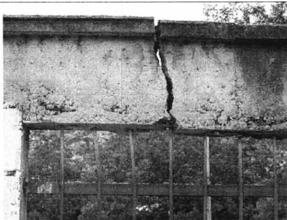
Foto 7. Fractura de las vigas de coronación superior.
