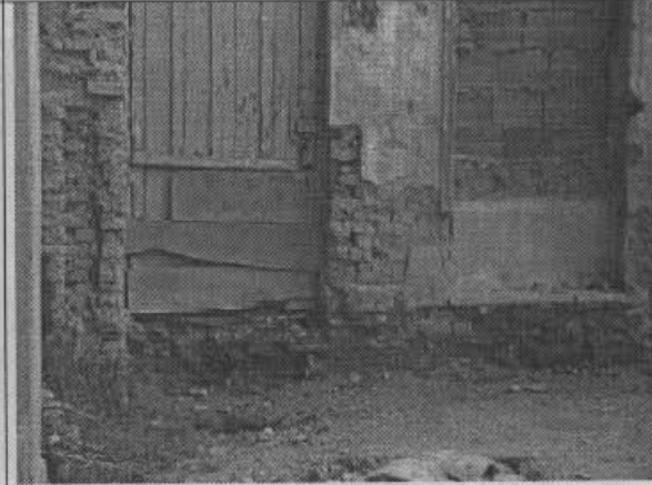
Foto 4. Pérdida de apoyo parte inferior.
