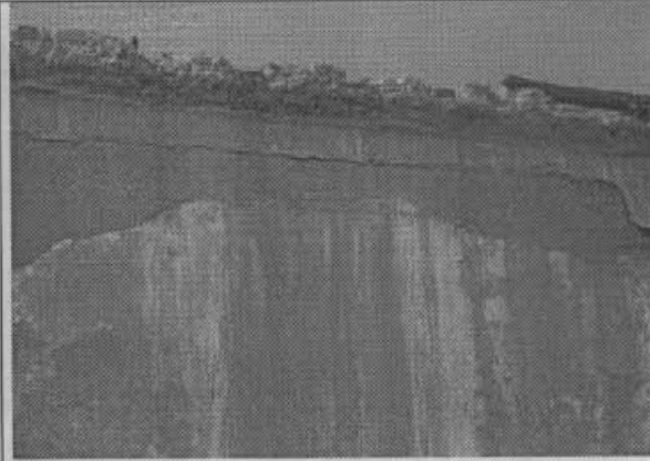
Foto 2. Desprendimiento de zonas del muro de cerramiento.
