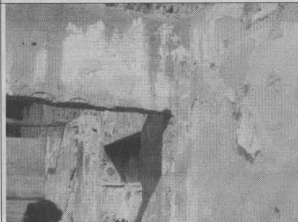
Foto 4. Desprendimiento de acabados en muros.
