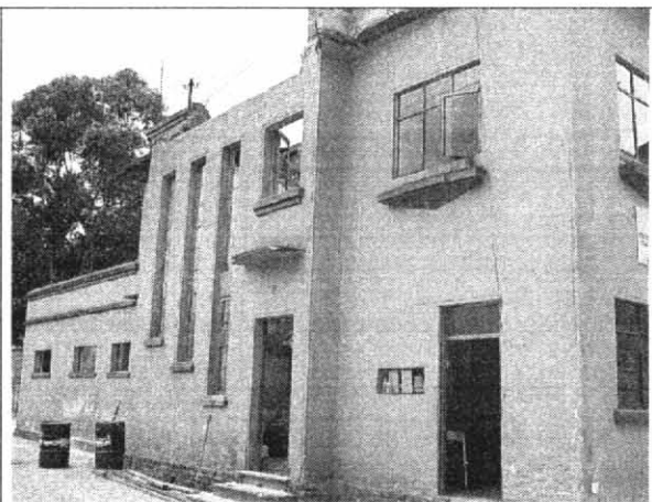
Foto 2. Condiciones de fachada sur al momento de la visita.
