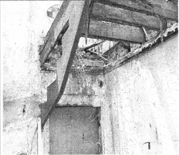
Foto 6. Colapso parcial de algunos elementos de madera.
