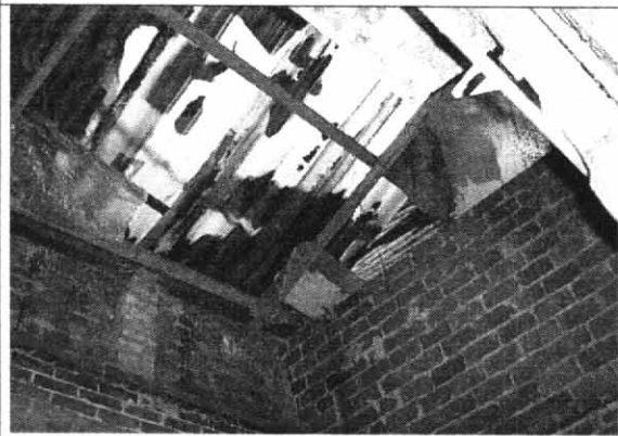
Foto 7. No hay un arriostramiento adecuado en la estructura de cubierta.
