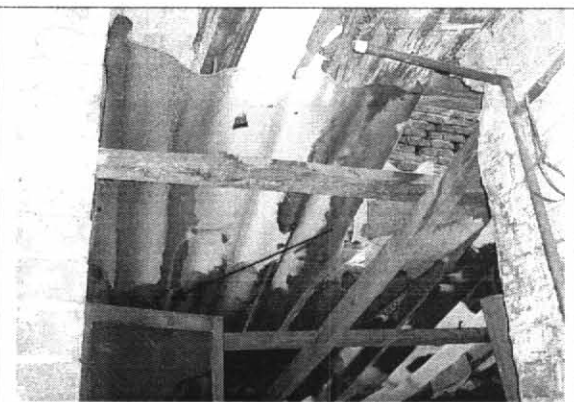
Foto 8. Se evidenció deficiente calidad de construcción en el costado posterior o sector oriental del inmueble.
