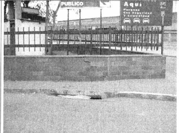
Foto 2. Agrietamiento del muro costado oriental.
