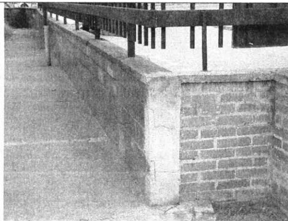
Foto 9. Fisuras en el muro, vista interna.
