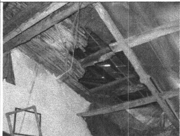
Foto 6. Cielos rasos colapsados.
