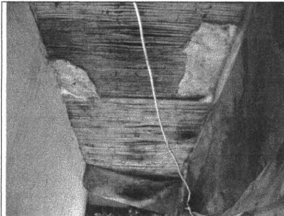
Foto 7. Cielos rasos colapsados.
