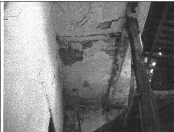
Foto 8. Cielos rasos en mal estado .
