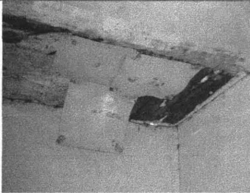
Foto 7. Cielos rasos con desprendimientos parciales.
