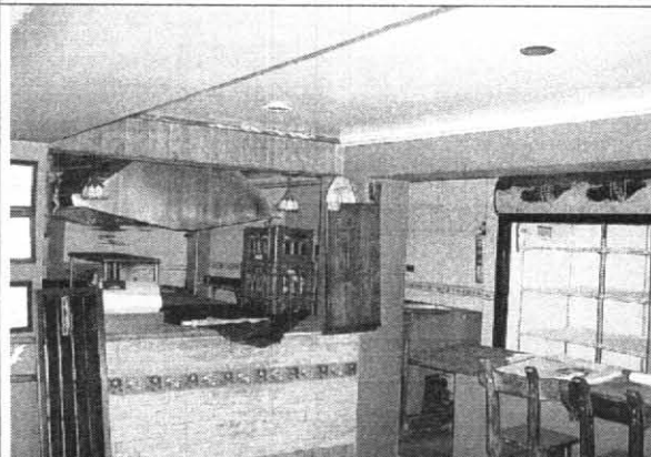
Foto 9. Vista general por el interior del inmueble, sin afectaciones estructurales que indiquen riesgo de colapso inminente.
