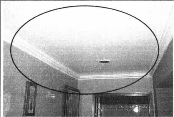
Foto 6. Fisuras superficiales en la placa de cubierta, vista por el interior del local comercial.
