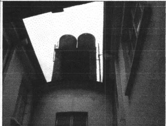
Foto 16. Tanques de agua en la cubierta.
