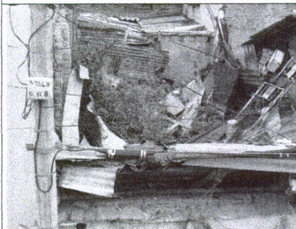
Foto 3. Colapso total de la estructura en el interior.
