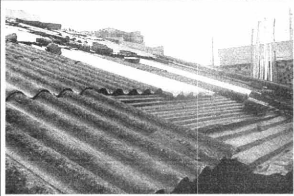
Foto 6. Deficiente amarre de las tejas en cubierta.
