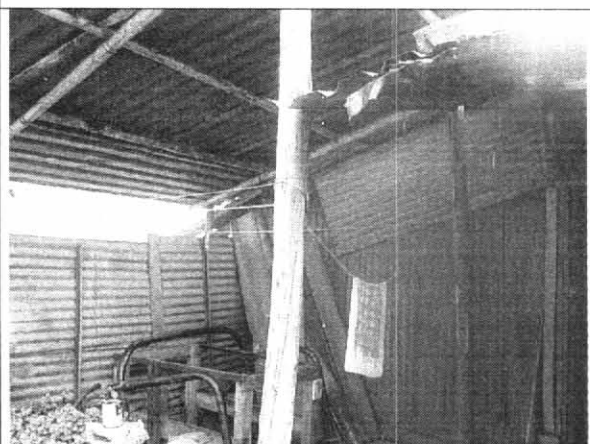
Foto 10. Deficiente arriostamiento en el entramado de cubierta en el sector de patio.
