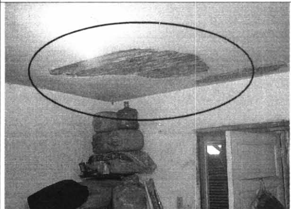
Foto 8. Desprendimiento de pañete en el cielo raso de cubierta.
