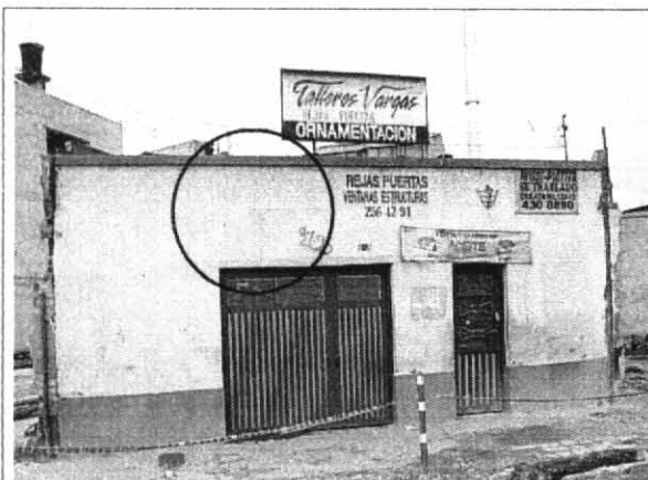
Foto 1. Condiciones de fachada en la edificación al momento de realizar la visita técnica. Agrietamiento leve.
