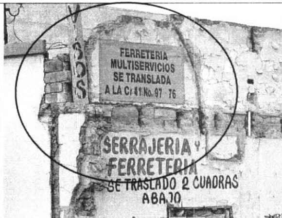
Foto 4. Deficiente calidad de construcción en los muros laterales de la edificación.
