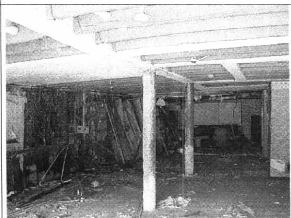
Foto 4. Deflexión excesiva del entrepiso y deterioro progresivo al interior del inmueble.
