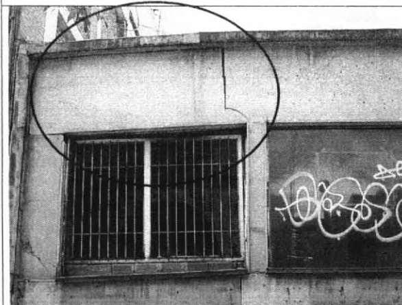
Foto 3. Deflexiones excesivas del muro fachada y agrietamiento del mismo.
