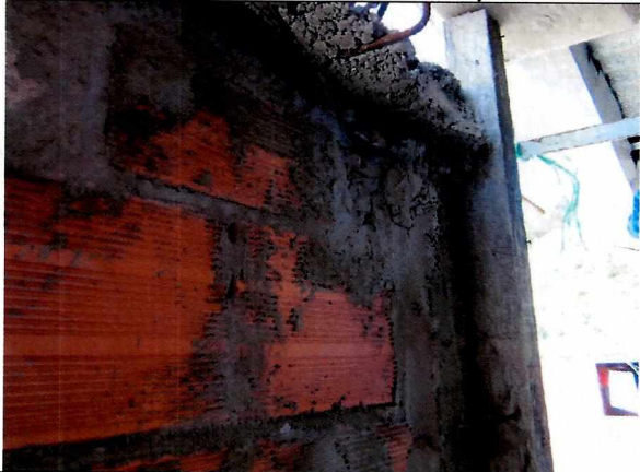
Foto 11. Muros y elementos de confinamiento, sin terminar.
