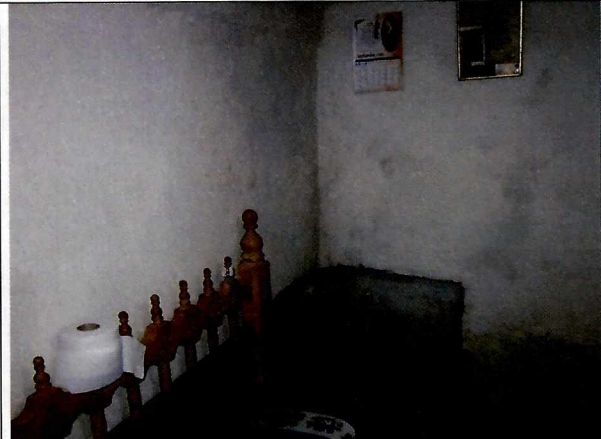
Foto 4. Deterioro de acabados de muros por humedad.
