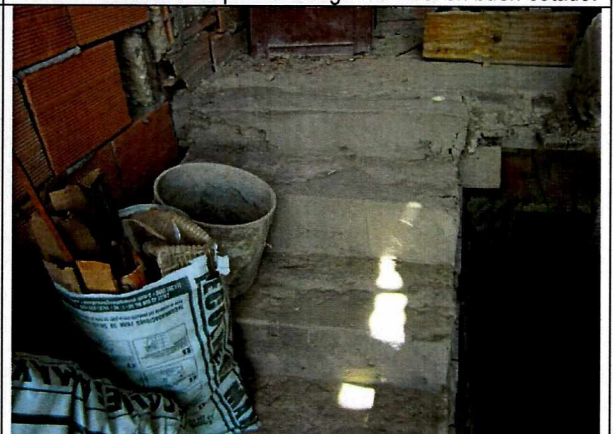
Foto 22. Escaleras a cubierta, daño leve, sin terminar.
