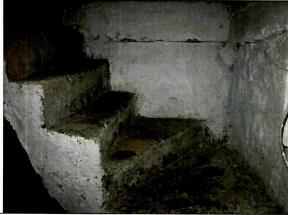
Foto 19. Escaleras de sótano a primer piso, daño leve.
