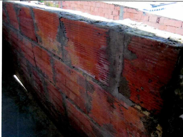
Foto 9. Antepecho de tercer nivel, daño leve y sin acabados.
