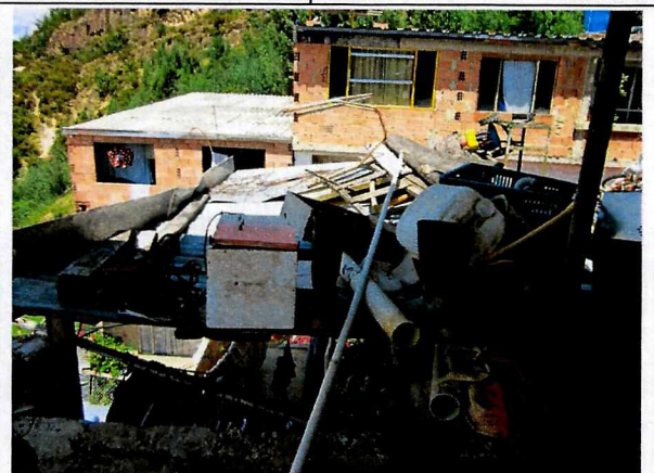
Foto 18. Zona de cubierta en lámina metálica, sobrecarga.
