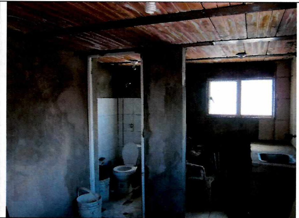
Foto 8. Muros y elementos sin acabados completos.
