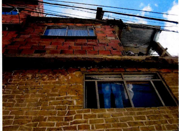
Foto 2. Muro de fachada sin acabados completos.
