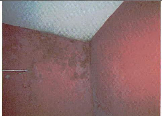
Foto 4. Humedad en la parte alta de muro del primer piso.
