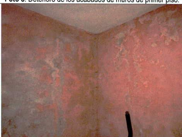
Foto 10. Muro sin daño pero con deterioro de acabados.
