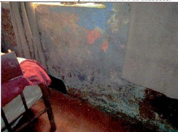
Foto 12. Deterioro de acabados generalizado.
