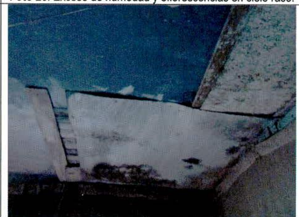
Foto 22. Reemplazos parciales del cielo raso.
