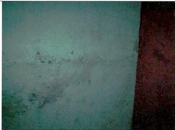
Foto 5. Deterioro de los acabados de muros por humedad.
