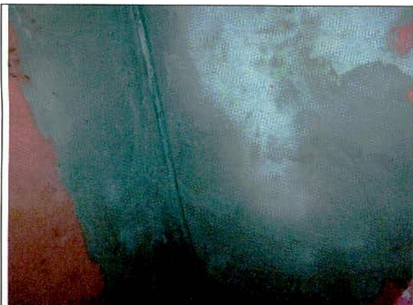
Foto 7. Evidente exceso de humedad en los muros internos.
