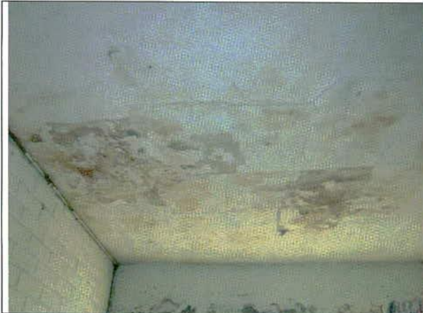
Foto 19. Deterioro de los acabados del cielo raso.
