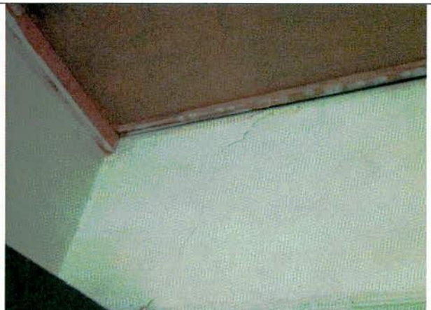
Foto 6. Fisuras en muro del primer piso.
