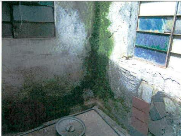
Foto 16. Muros en patio interno, exceso de humedad.
