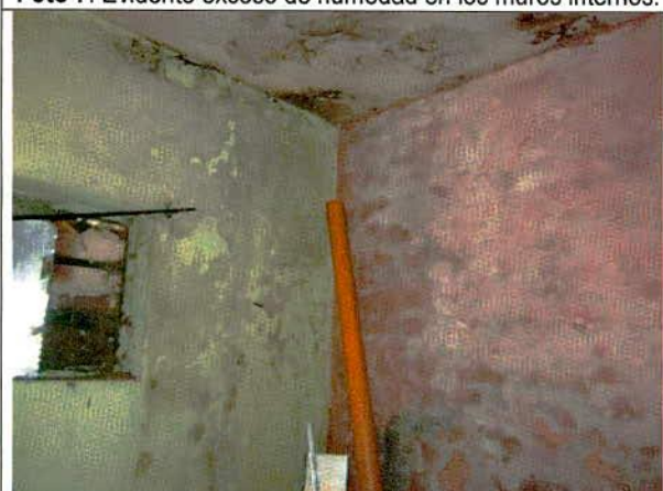
Foto 9. Humedad en los muros del sector medio y posterior.
