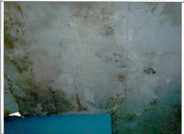
Foto 21. Deterioro generalizado del cielo raso por humedad.
