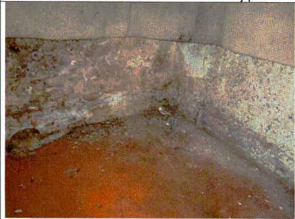
Foto 11. Deterioro fuerte por exceso de humedad en muros.
