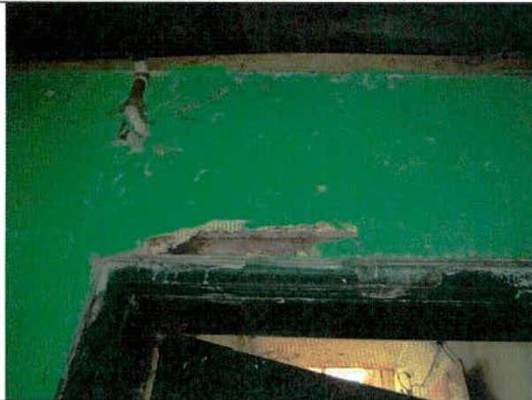
Foto 15. Fisura y daño en dintel de primer piso.
