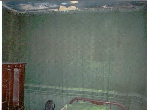
Foto 13. Muros en buen estado estructural, humedad.
