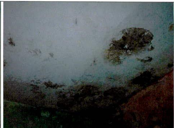
Foto 20. Exceso de humedad y eflorescencias en cielo raso.
