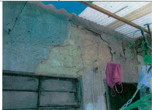
Foto 18. Desprendimiento del pañete de recubrimiento.
