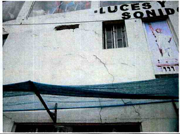
Foto 4. Agrietamientos en el muro de fachada.
