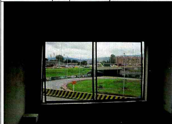
Foto 17. Deformación de vanos de ventanas.
