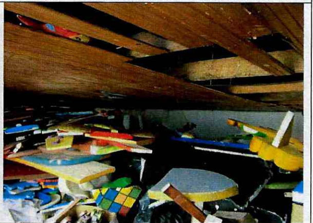
Foto 26. Desprendimiento de los listones del cielo raso.
