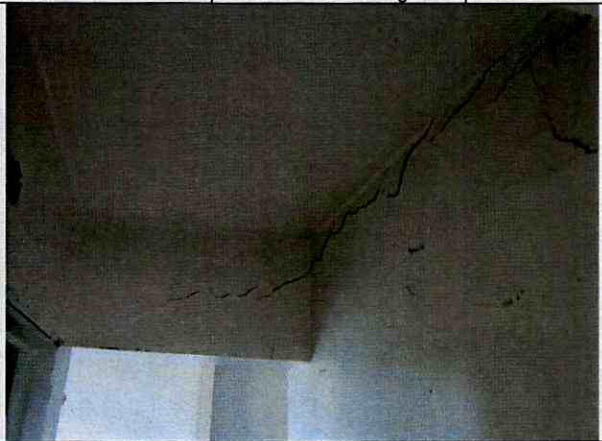
Foto 14. Grietas en los muros y dinteles de segundo piso.
