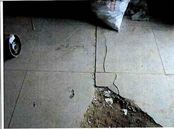
Foto 27. Grietas y daño de acabados del piso.
