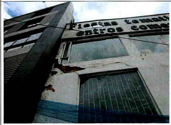
Foto 5. Grietas y desprendimiento del pañete de fachada.
