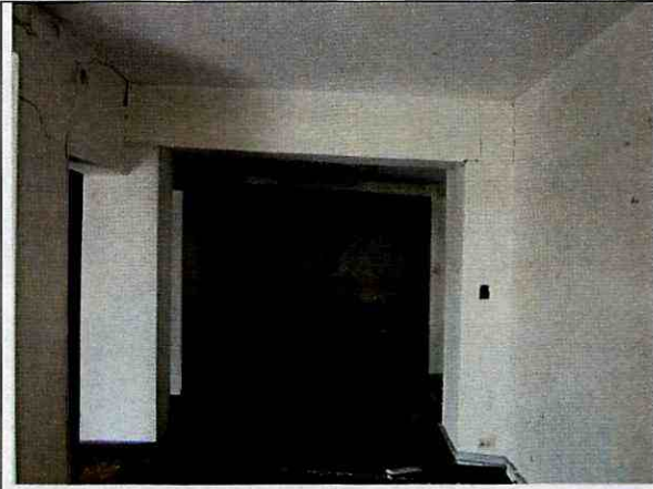
Foto 9. Evidente deformación de muros y marcos.
