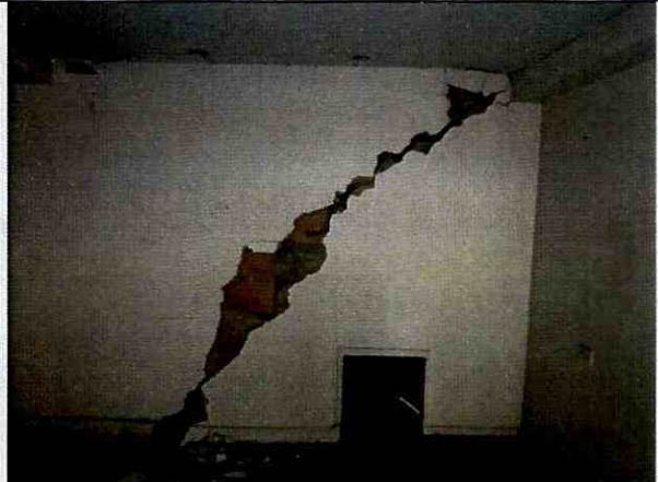
Foto 10. Fractura de muro en el primer piso.
