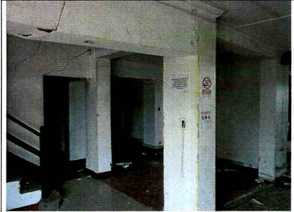
Foto 7. Elementos internos de primer piso.
