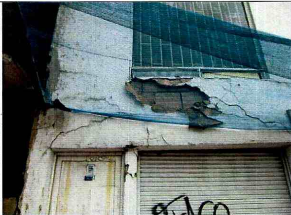
Foto 6. Daño del muro de fachada, costado oriental.
