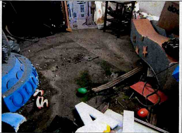
Foto 22. Deterioro del entrepiso de tercer nivel.
