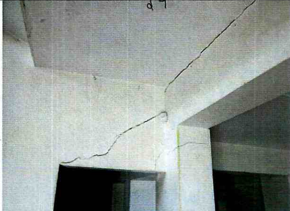
Foto 8. Agrietamientos en dintel de primer piso.
