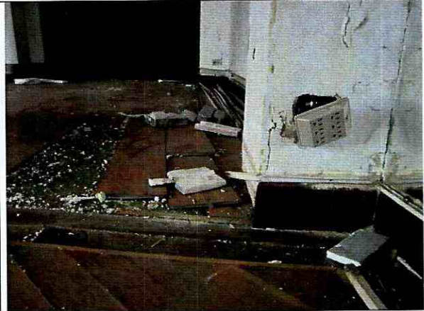
Foto 28. Hundimientos y deterioro de la placa de piso.
