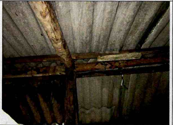
Foto 25. Deterioro de los elementos de cubierta.
