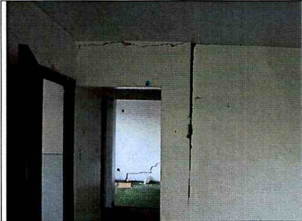
Foto 15. Grietas por separación de la junta entre elementos.
