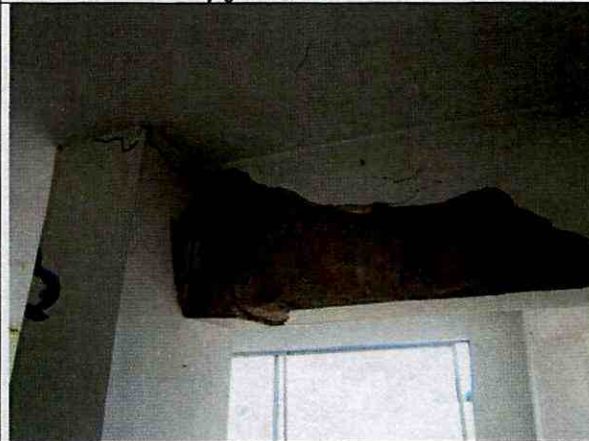
Foto 13. Grietas y desprendimiento de acabados de muros.
