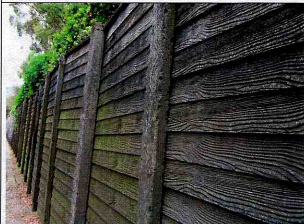
Foto 5. Deformaciones del cerramiento.
