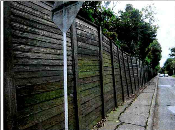
Foto 9. Deformación del cerramiento, grietas en el andén.
