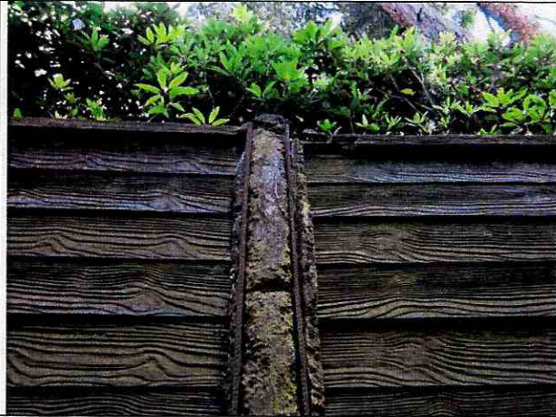
Foto 15. Acero de refuerzo de los postes expuestos.
