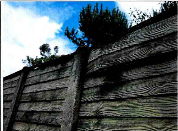
Foto 10. Fractura de placas de concreto.
