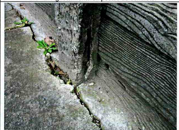
Foto 14. Desprendimiento del recubrimiento.
