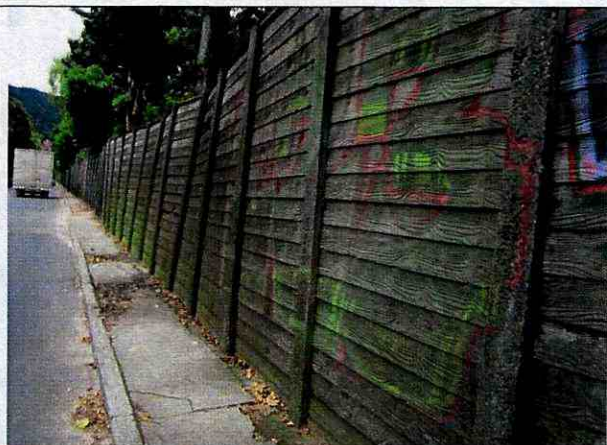
Foto 6. Tramos con pérdida de verticalidad.
