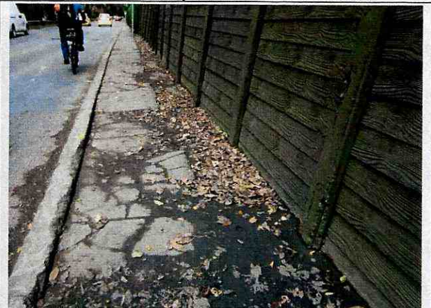
Foto 20. Deterioro y deformaciones del andén.
