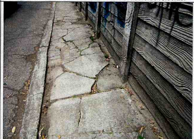
Foto 18. Grietas y deformaciones del andén.
