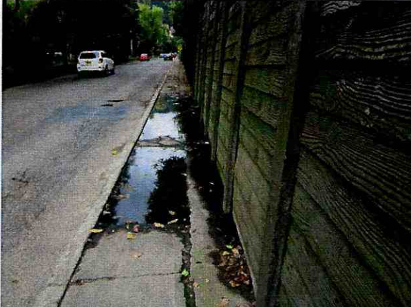
Foto 19. Hundimientos y deformación del piso.
