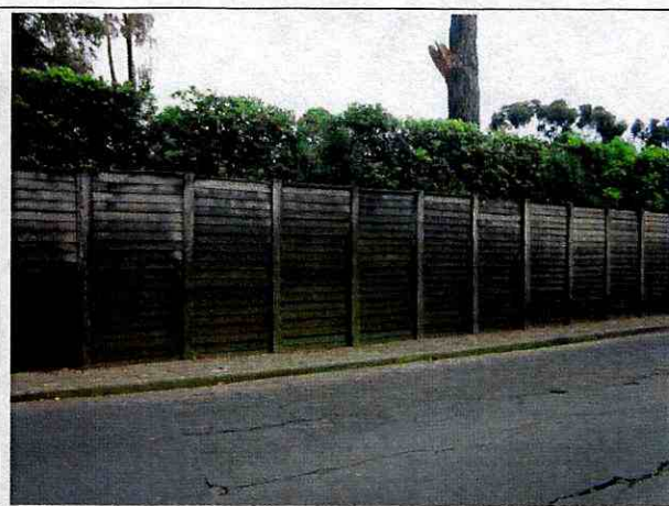
Foto 4. Deterioro por humedad.
