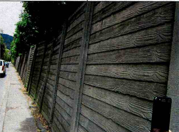
Foto 8. Deformaciones y daños en varios tramos.
