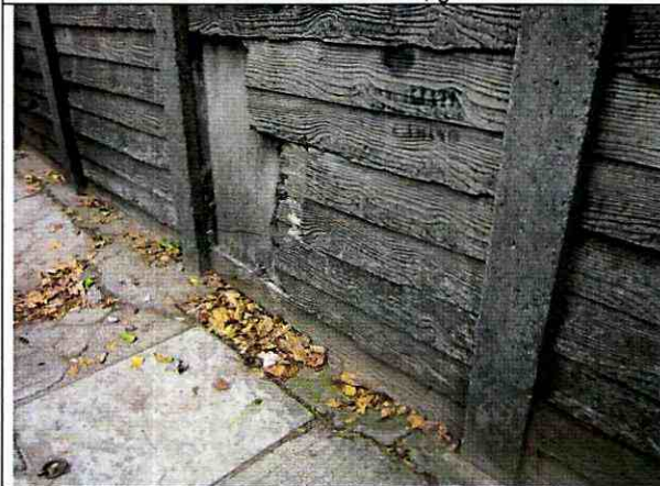
Foto 11. Rotura de placas de concreto.
