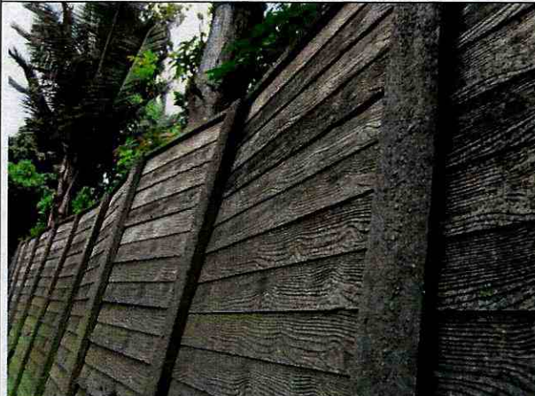
Foto 7. Sentido de caída hacia el interior.
