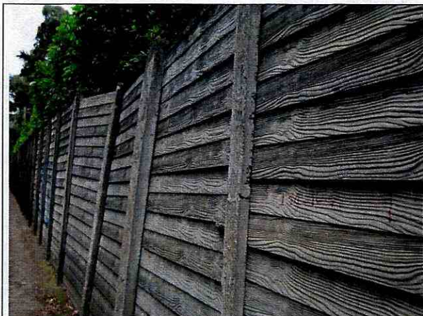
Foto 3. Pérdida de verticalidad del cerramiento.
