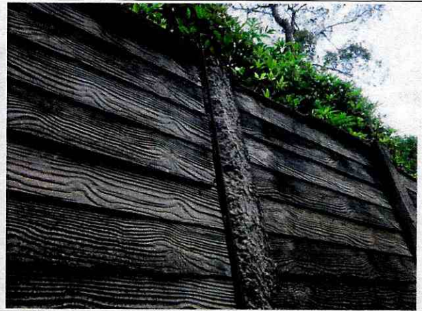
Foto 16. Pérdida del recubrimiento del acero de refuerzo.
