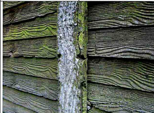
Foto 13. Grietas verticales en los postes del cerramiento.
