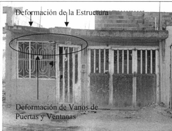
Foto 1. Fachada de la edificación, estructura deformada.
