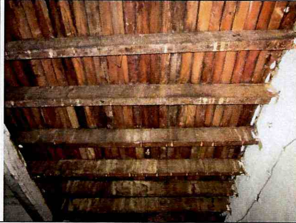
Foto 21. Elementos del entrepiso en buen estado, deterioro.
