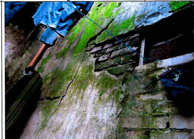
Foto 8. Desprendimiento del pañete de recubrimiento.
