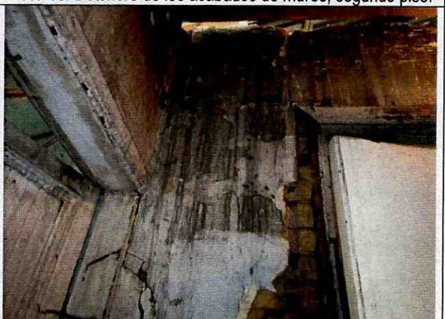
Foto 12. Deterioro de los acabados en muros posteriores.
