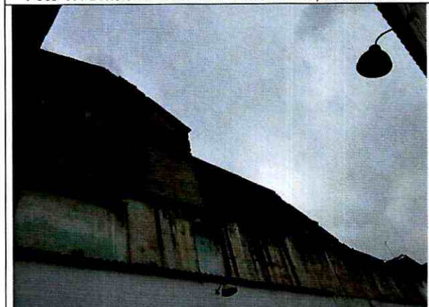
Foto 19. Muro de culata del costado sur, deterioro.
