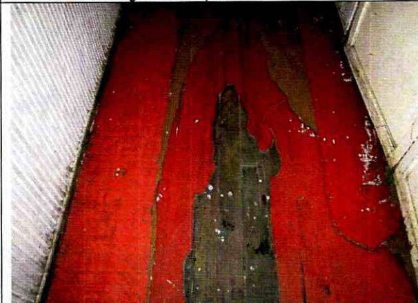
Foto 20. Deterioro de los listones del entrepiso.
