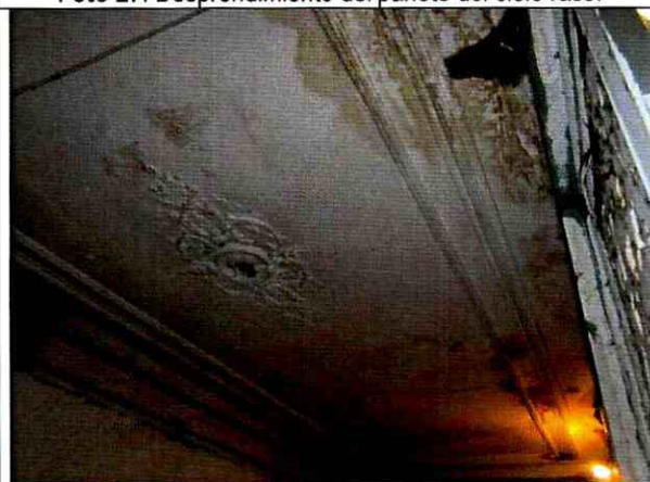
Foto 29. Cielo raso original con deterioro por humedad.
