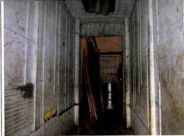
Foto 3. Muros internos de primer piso, deterioro leve.
