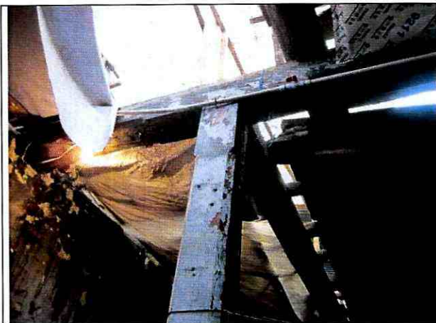
Foto 15. Elementos de madera con daño moderado.
