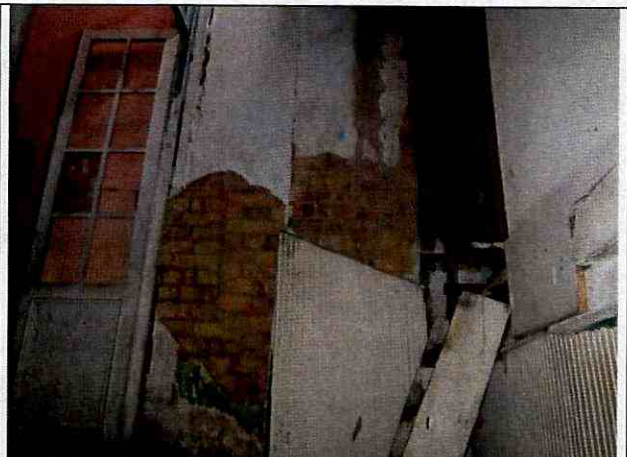
Foto 10. Deterioro de los acabados de muros, segundo piso.
