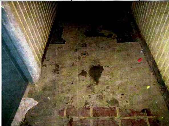
Foto 32. Placa de piso, deterioro fuerte de los acabados.
