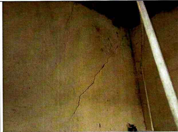
Foto 5. Fisuras y grietas en muros de primer piso.
