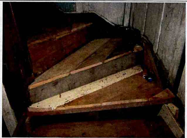
Foto 24. Escaleras a tercer piso, reparaciones y deterioro.
