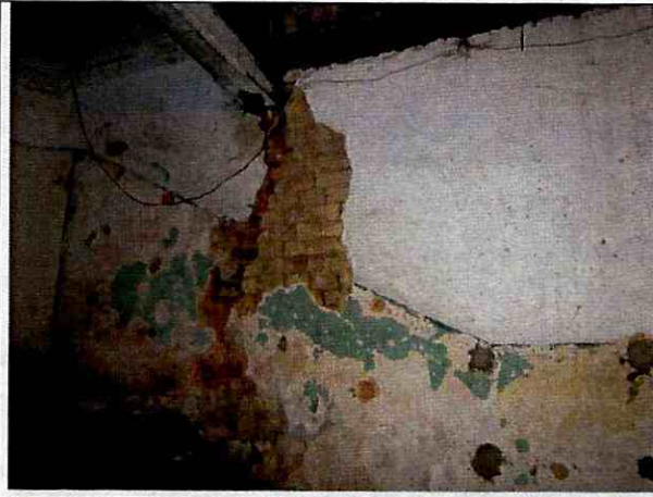
Foto 9. Muros internos, desprendimiento del pañete.
