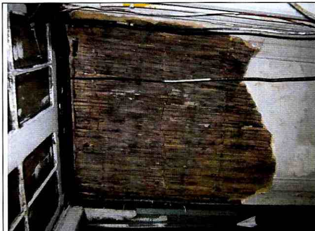
Foto 27. Desprendimiento del pañete del cielo raso.
