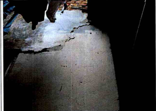
Foto 6. Agrietamiento en muro del patio.
