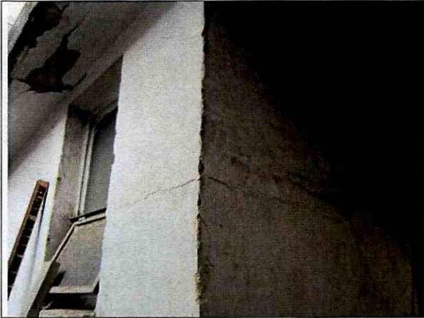
Foto 13. Fisuras en muros del sector del patio.
