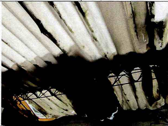
Foto 32. Deterioro de tejas plásticas, patio y lavadero.
