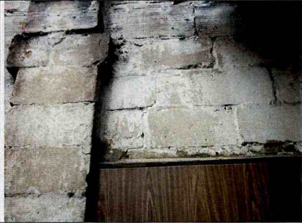
Foto 14. Fisura en muro del patio, costado occidental.
