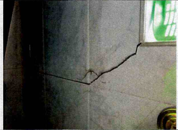
Foto 26. Agrietamiento en muro del baño, segundo piso.
