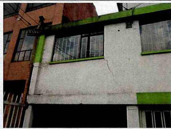
Foto 2. Agrietamiento en muro de fachada.
