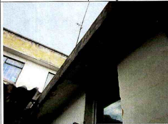
Foto 33. Deterioro de los acabados de la placa de cubierta.
