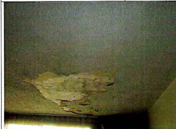
Foto 32. Deterioro de los acabados de la placa.
