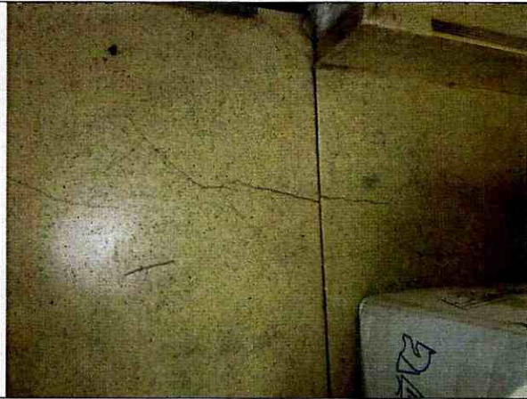
Foto 32. Fisuras en la superficie, descanso escalera.
