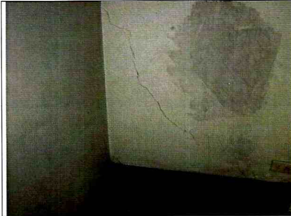
Foto 19. Agrietamiento en muro del primer piso.
