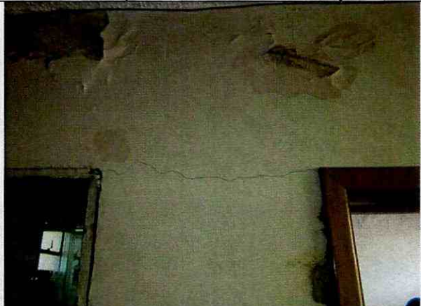
Foto 30. Fisura en muro del hall del segundo piso.
