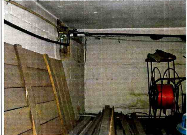
Foto 8. Grieta y fisuras en muros del mezzanine.
