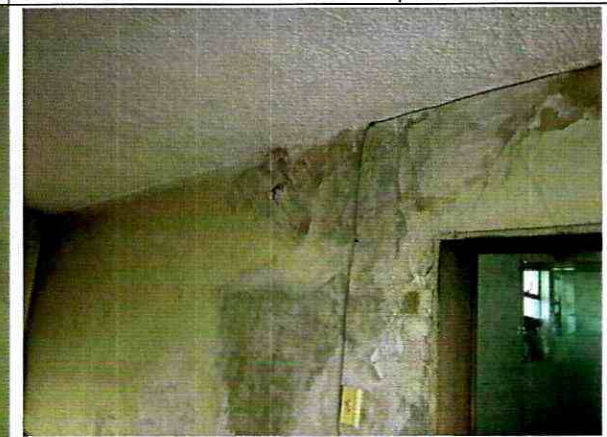
Foto 24. Deterioro de los acabados de muros por humedad.
