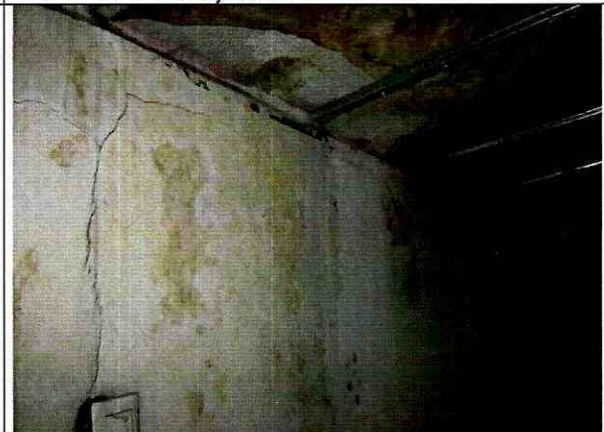
Foto 10. Deterioro generalizado de los muros posteriores.
