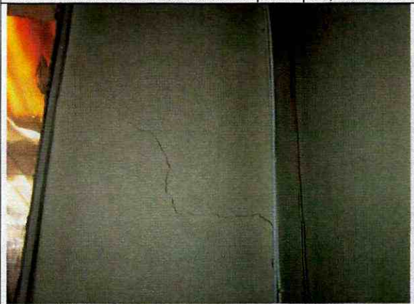
Foto 17. Fisura de muro interno de primer piso.
