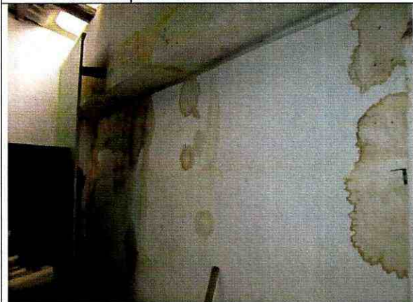
Foto 9. Deterioro por humedad en muros posteriores.
