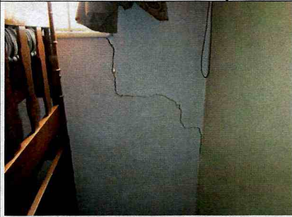
Foto 29. Grieta diagonal, muro de segundo nivel.
