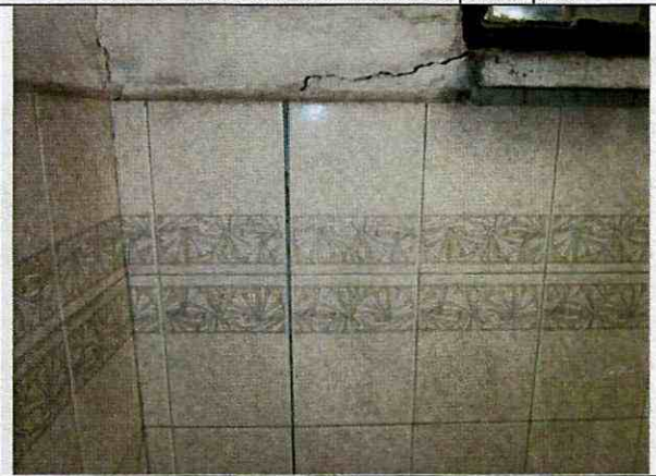
Foto 18. Grieta en muro del costado occidental.
