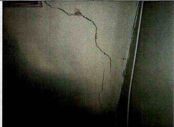
Foto 16. Grieta en muro interno del primer piso.
