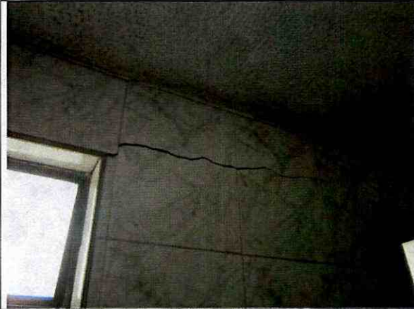
Foto 25. Grieta en muro del baño del segundo nivel.
