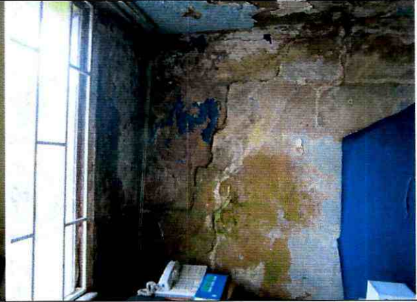
Foto 20. Grieta en muro de segundo piso esquina nororiental.
