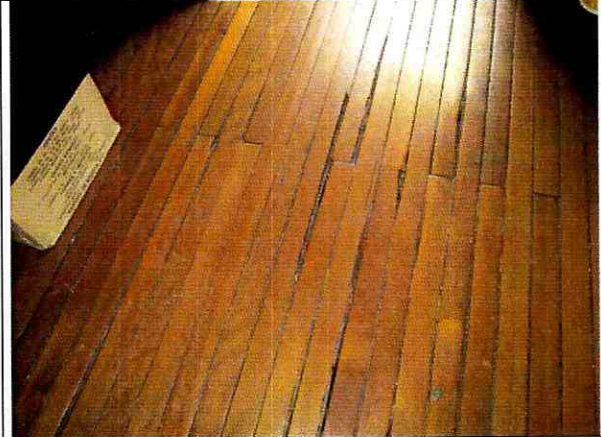
Foto 32. Deterioro de los listones de madera de acabado.
