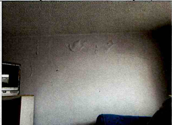
Foto 28. Fisuras y deterioro, muro oriental del segundo piso.
