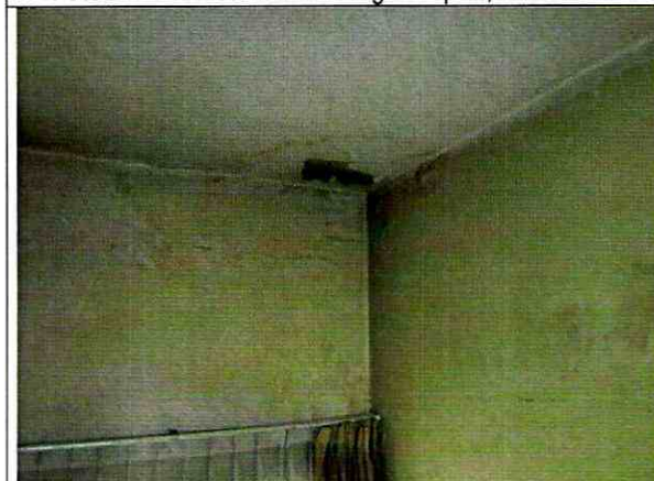
Foto 23. Deterioro de acabados por exceso de humedad.
