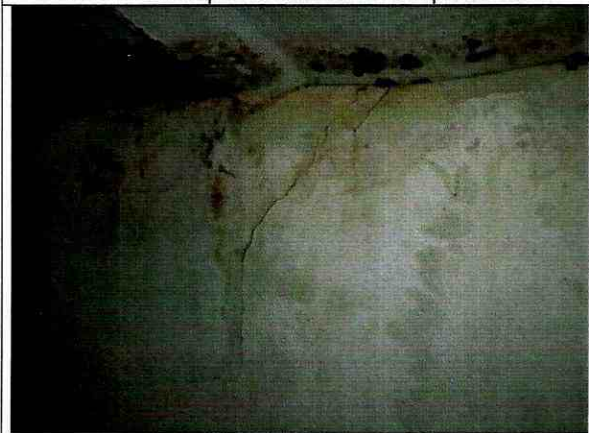
Foto 11. Grietas y deterioro de muros, sector posterior.
