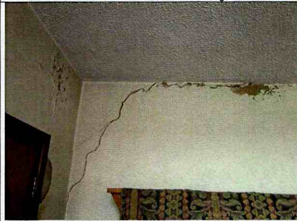
Foto 27. Grieta en habitación oriental del segundo nivel.
