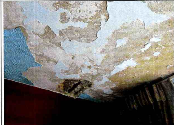
Foto 32. Deterioro y desprendimiento del recubrimiento.
