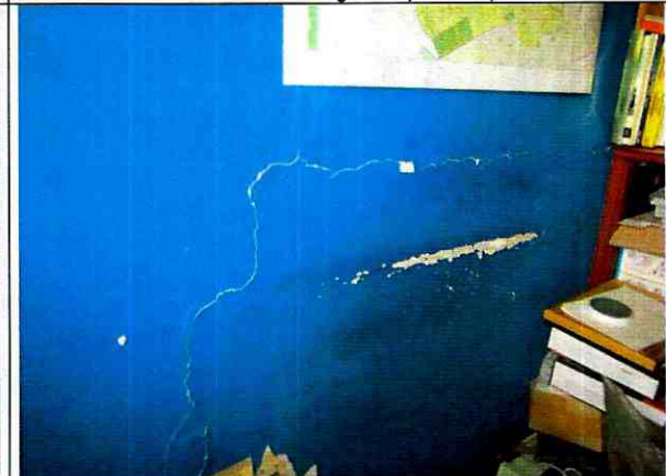
Foto 22. Grieta en muros de la esquina nororiental.
