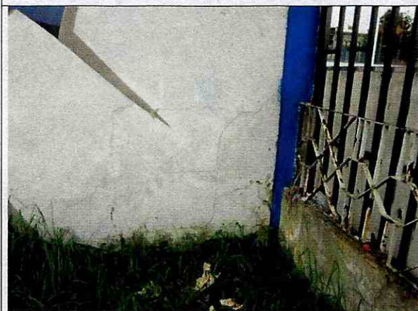
Foto 5. Fisuras en la esquina suroccidental.
