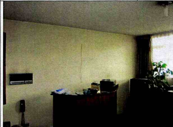
Foto 15. Muros del sector frontal del primer piso, daño leve.
