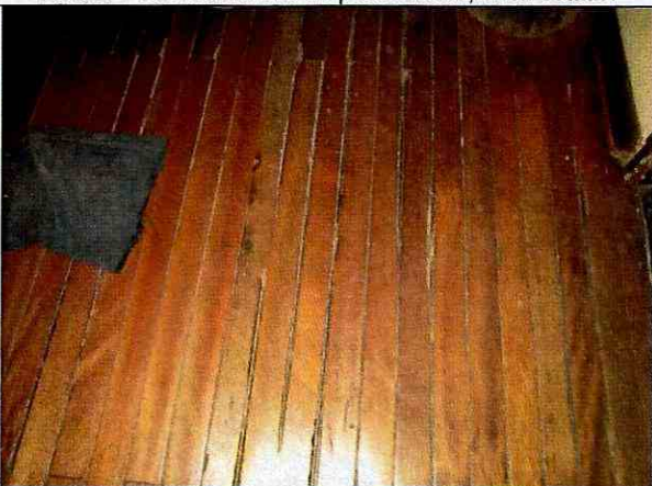
Foto 32. Deterioro de los listones de madera del piso.
