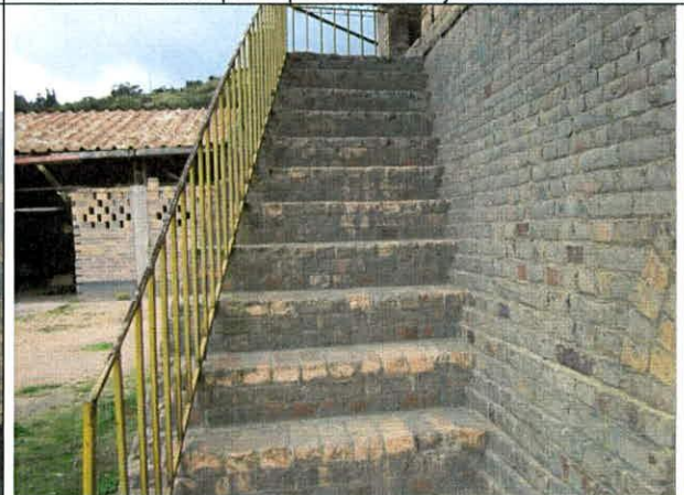
Foto 10. Escalera en mampostería sin daño visible, deterioro.
