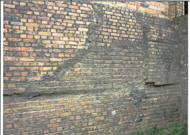
Foto 34. Fractura a lo largo del muro, daño severo.
