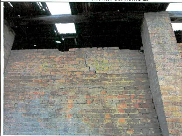
Foto 27. Grieta en muro superior.
