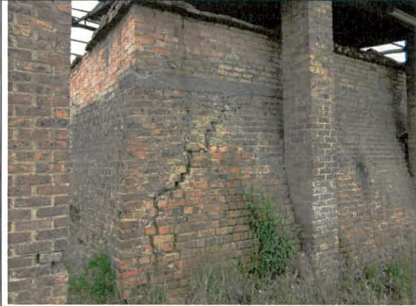
Foto 31. Fractura con varios centímetros de separación.
