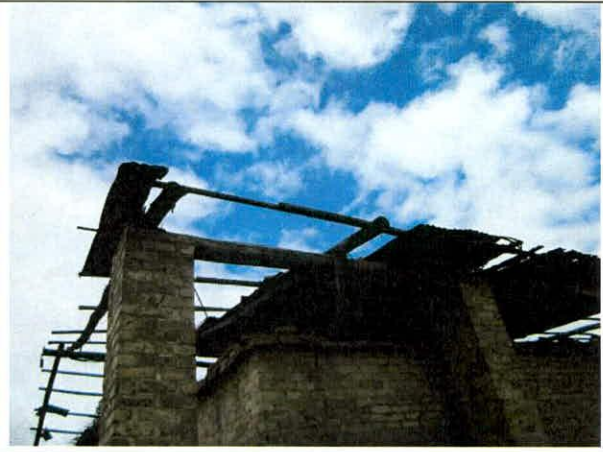
Foto 42. Pérdida de tejas de la cubierta del horno 2.
