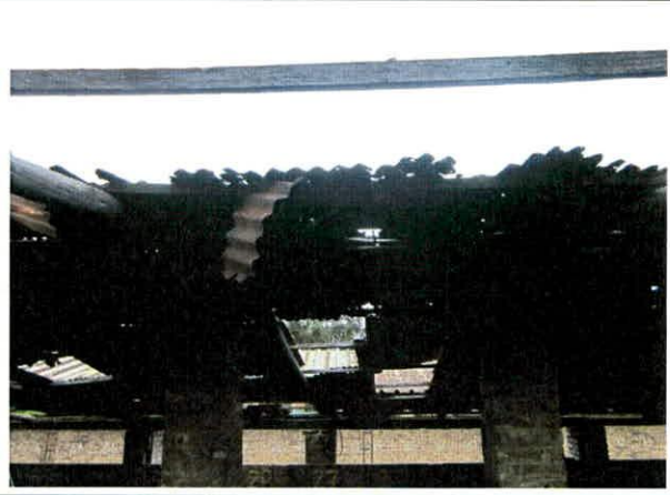
Foto 44. Daño de las tejas metálicas.
