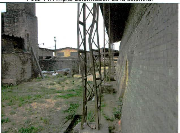
Foto 16. Columnas con deformaciones evidentes.
