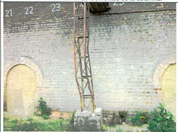
Foto 15. Daño por deformación de la columna.
