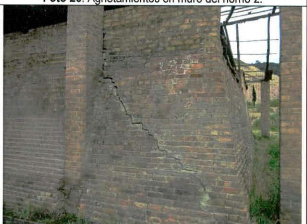
Foto 28. Fractura diagonal en la esquina del horno.
