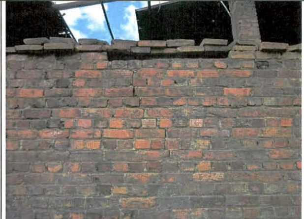
Foto 30. Agrietamiento en parte alta del muro posterior.
