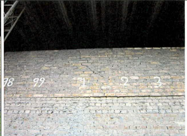
Foto 6. Grieta en el muro de la parte superior.
