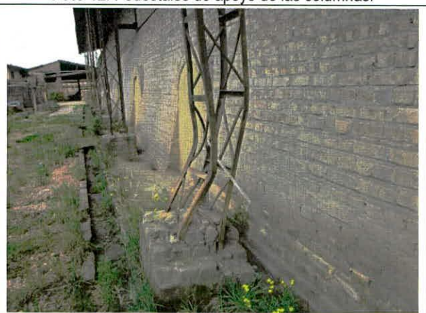
Foto 14. Amplia deformación de la columna.
