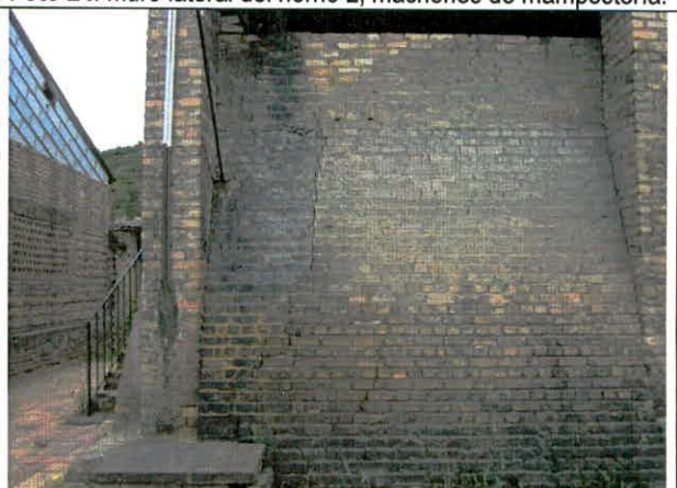
Foto 26. Agrietamientos en muro del horno 2.
