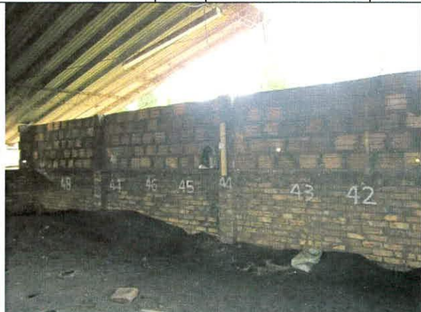
Foto 9. Deterioro de los muros de mampostería.
