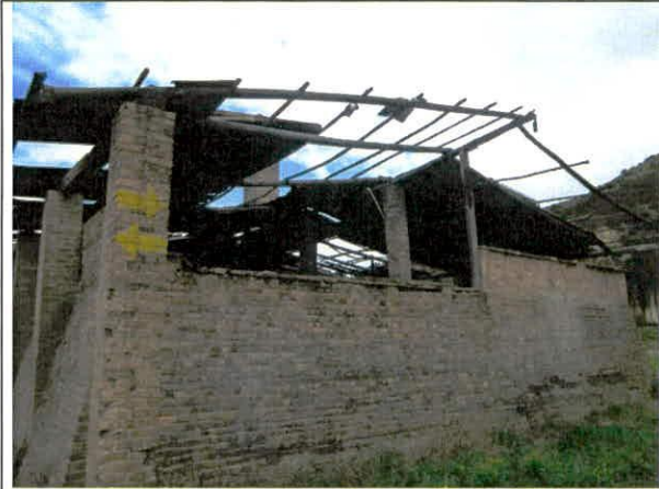
Foto 29. Muro posterior, grietas y deterioro.
