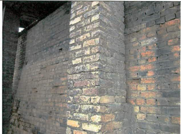
Foto 36. Grietas en columna de mampostería.
