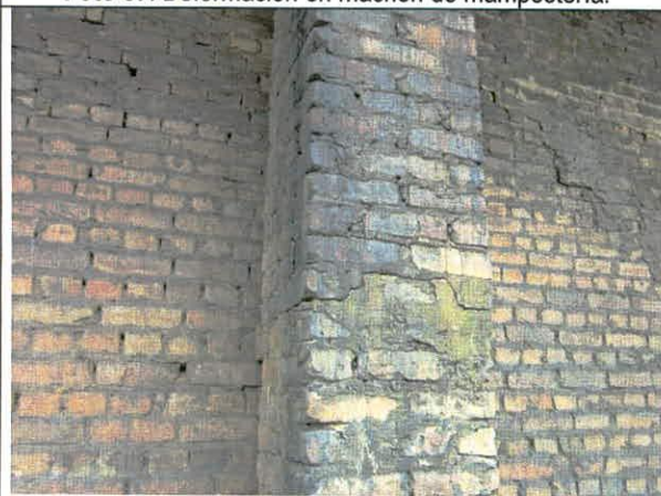
Foto 39. Grietas en los machones de apoyo de la cubierta.
