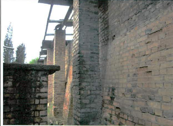
Foto 37. Deformación en machón de mampostería.
