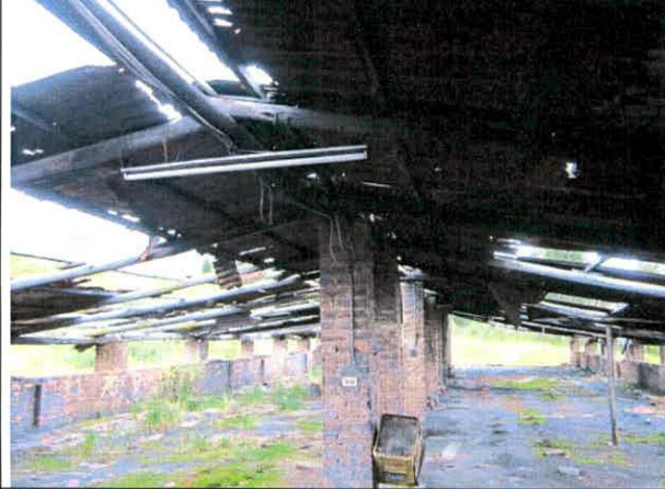
Foto 43. Deterioro generalizado de elementos de cubierta.
