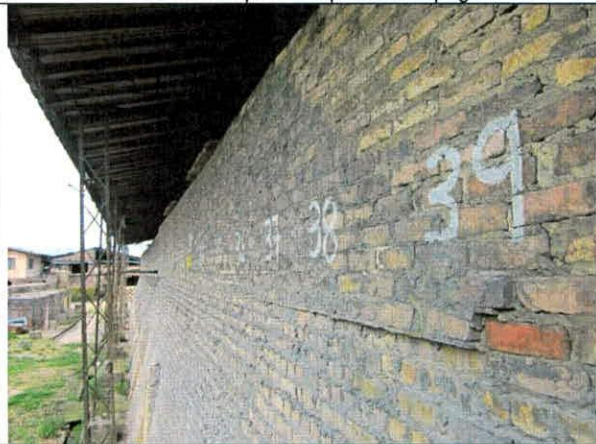
Foto 7. Deformación por desplazamiento del muro superior.
