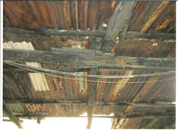
Foto 45. Daño de los elementos de madera rolliza.
