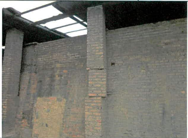
Foto 38. Fractura del machón, condición inestable.
