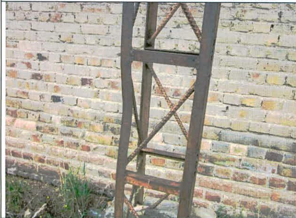
Foto 13. Deformación de elementos de la columna.
