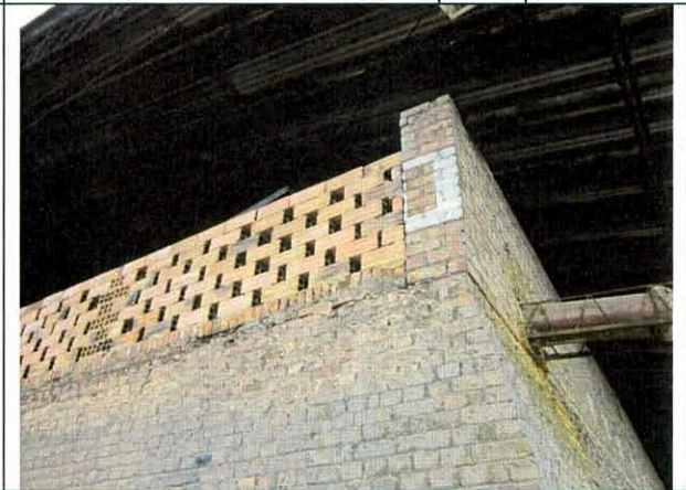
Foto 8. Grietas por separación de la junta entre muros.
