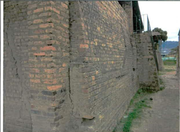
Foto 33. Fractura y deformación del muro frontal.
