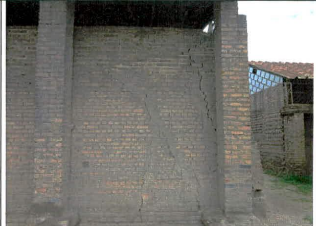
Foto 32. Grietas y fracturas, daño severo del muro.
