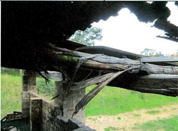
Foto 46. Deterioro de la madera de la estructura de cubierta.
