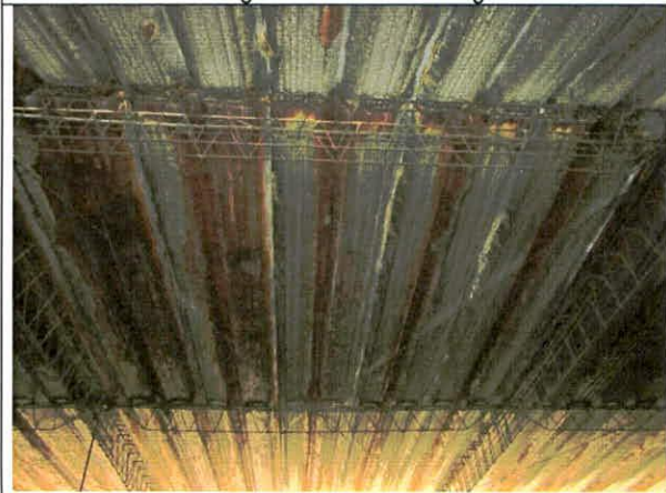
Foto 19. Deterioro incipiente de las canaletas por corrosión.
