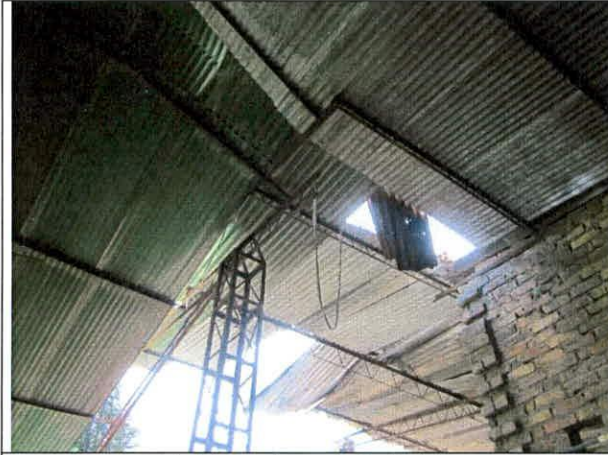
Foto 7. Desplazamiento de tejas.
