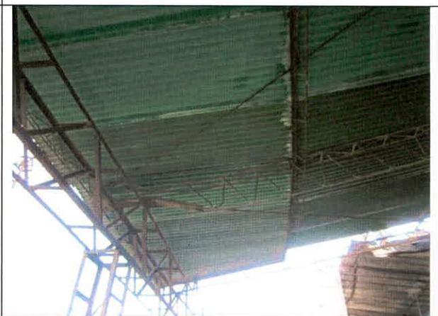
Foto 6. Deformación de viga metálica en celosía.
