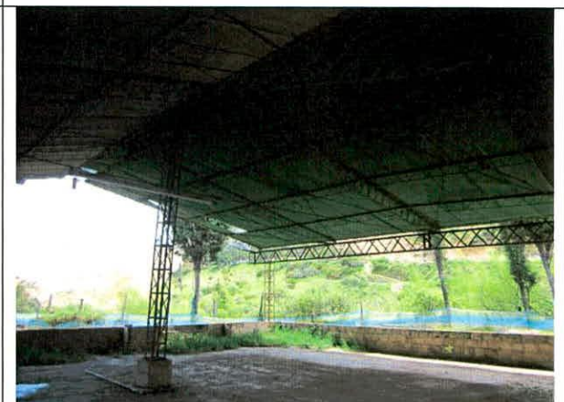
Foto 4. Elementos en regulares condiciones estructurales.
