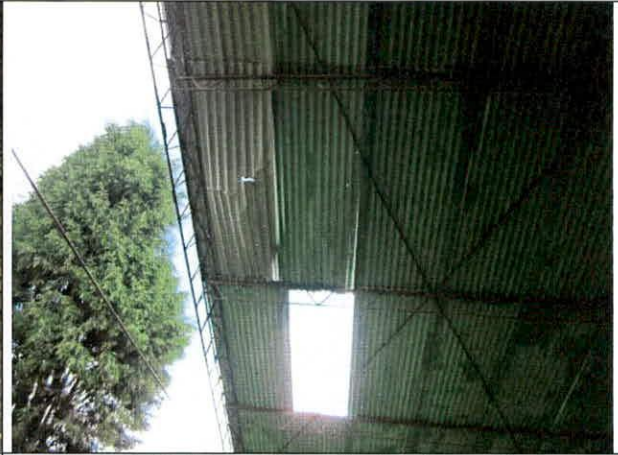
Foto 8. Pérdida y deformación de tejas metálicas.
