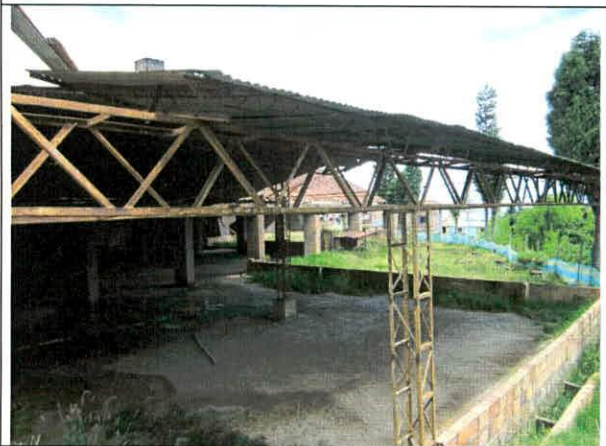
Foto 5. Vigas y columnas, corrosión incipiente.
