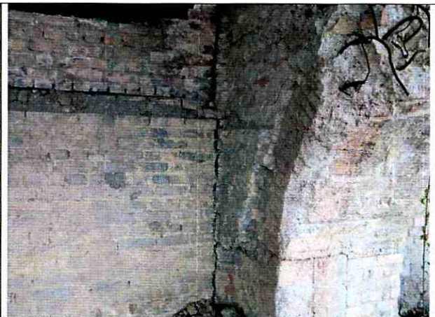
Foto 14. Grietas en vértices de unión entre muros.
