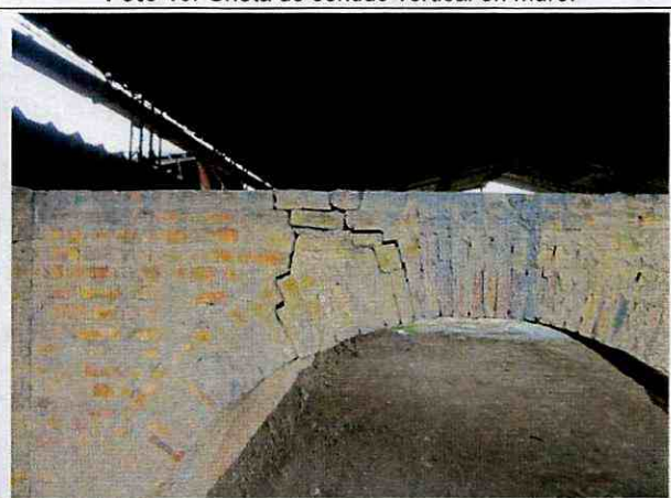
Foto 12. Fractura de la mampostería en arco.
