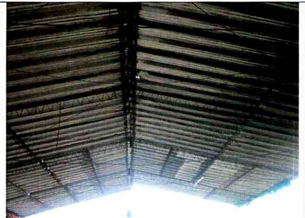
Foto 6. Tensor de cubierta deformado y sin tensión.
