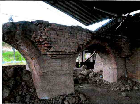
Foto 15. Deterioro de muros y condición inestable.
