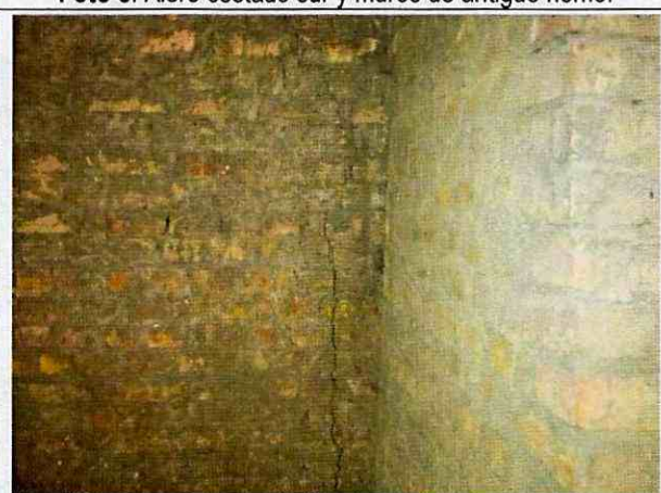
Foto 10. Grieta de sentido vertical en muro.
