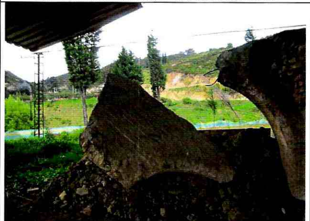
Foto 16. Escombros y fragmentos de muros sueltos.
