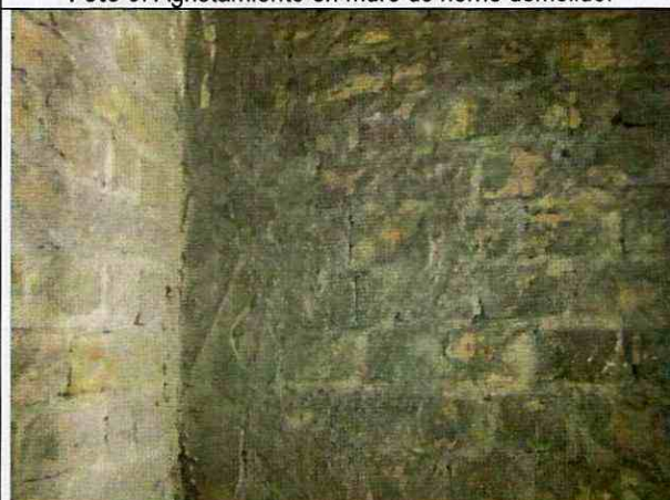
Foto 11. Grietas, fisuras y deterioro de la mampostería.
