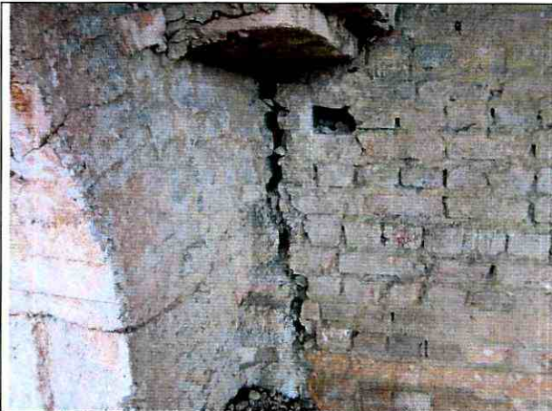
Foto 13. Fractura con varios centímetros de separación.
