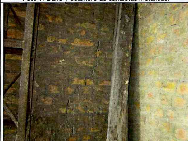
Foto 9. Agrietamiento en muro de horno demolido.
