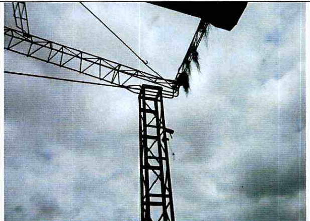
Foto 4. Deterioro, corrosión y pérdida de elementos.
