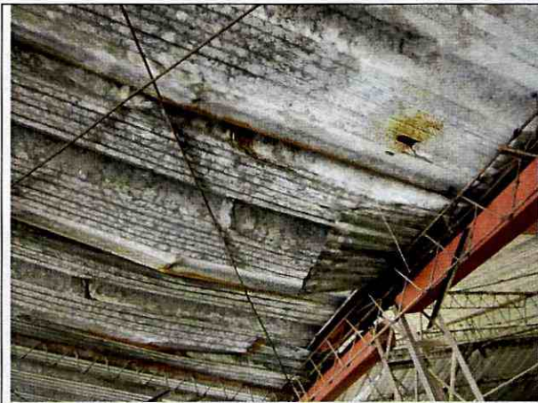
Foto 7. Daño y deterioro de canaletas metálicas.
