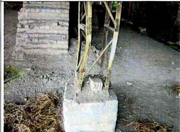
Foto 5. Deformación excesiva de elementos estructurales.
