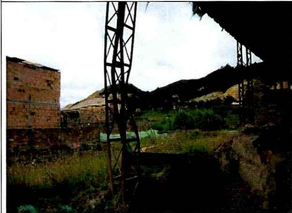
Foto 3. Daño fuerte de columna metálica, deformación.
