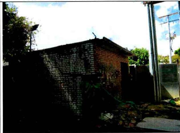
Foto 11. Asentamientos diferenciales, acumulación de escombros
