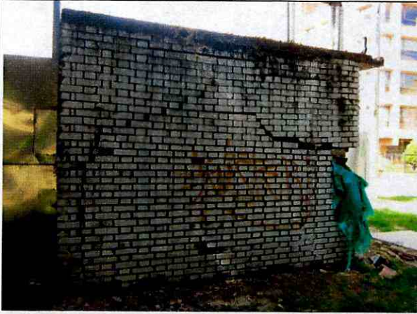
Foto 3. Muro norte con daño severo, deterioro de la placa.
