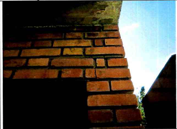
Foto 10. Grieta en la parte superior del muro occidental.
