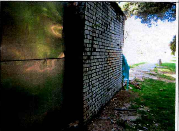
Foto 4. Pérdida de verticalidad del muro del costado norte.
