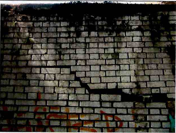
Foto 5. Fractura con varios centímetros de separación
