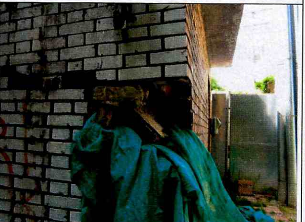
Foto 6. Desprendimiento de piezas de mampostería.
