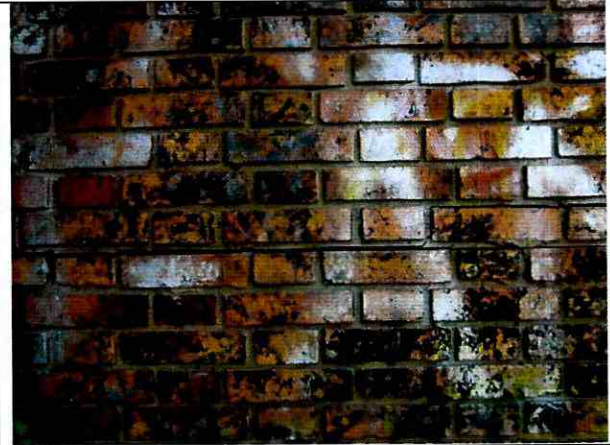
Foto 8. Agrietamiento en el muro del costado occidental.
