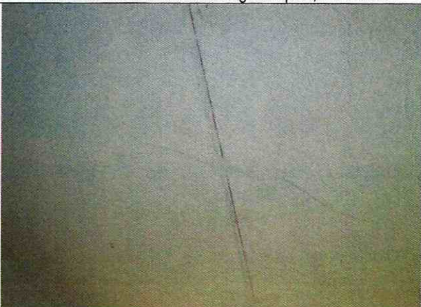
Foto 18. Fisura en cara inferior de la placa de entepiso.
