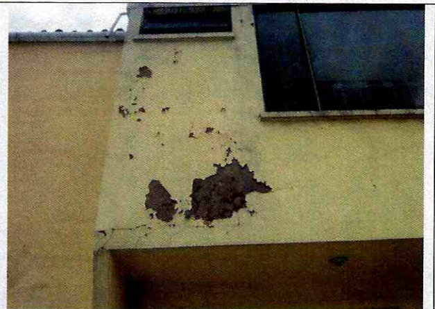
Foto 4. Deterioro puntual de los acabados de la fachada.
