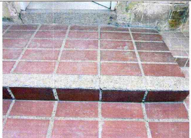
Foto 24. Fisura y leve deformación en el piso de la entrada.
