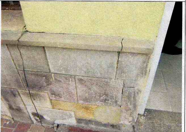
Foto 6. Fisura en los acabados de piedra de la entrada.
