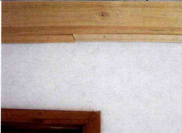
Foto 16. Fisura en muro de segundo piso, daño leve.
