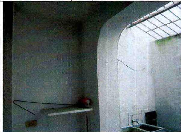
Foto 11. Deterioro leve de muros internos.
