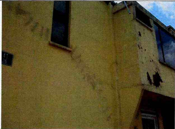
Foto 3. Fisura y grietas en el muro de fachada.
