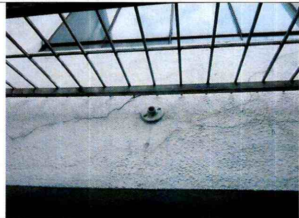
Foto 12. Daño leve de muros internos del sector posterior.
