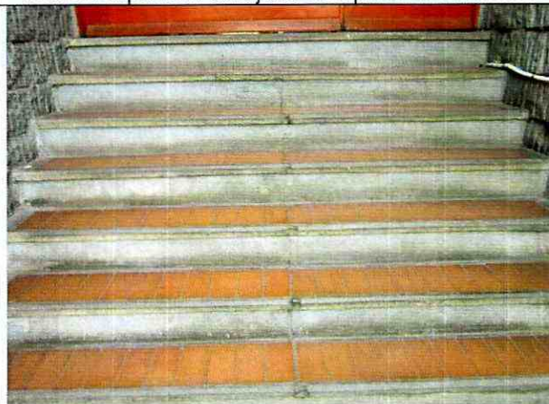
Foto 24. Escaleras sobre terreno en buen estado, daño leve.
