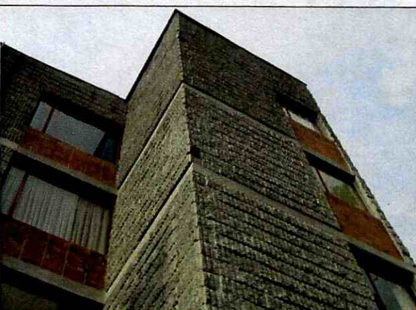
Foto 4. Daño menor en muro de fachada lateral.
