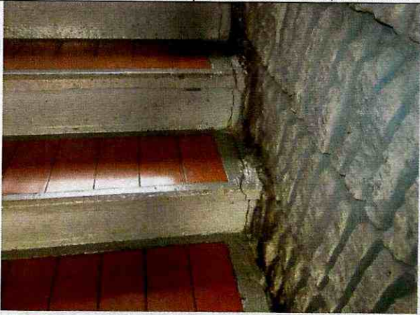
Foto 15. Grieta por junta entre muro y escalera.
