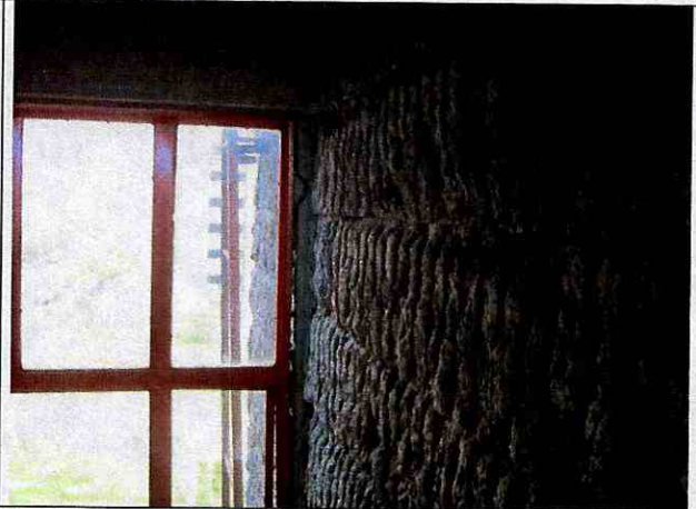
Foto 14. Aumento de la separación de la junta de la ventana.
