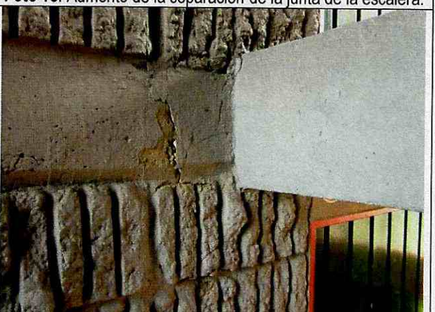
Foto 18. Grieta en punto de apoyo del dintel de la placa.
