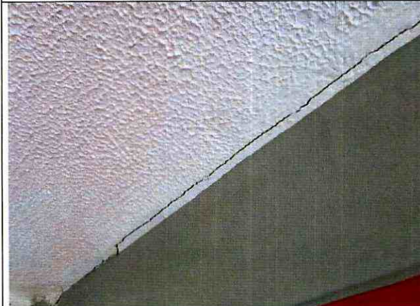
Foto 21. Separación de la junta entre placa y muro.
