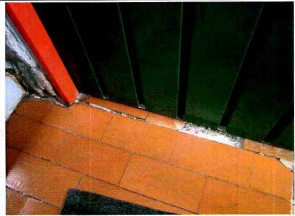
Foto 22. Separación de la junta de la placa en último nivel.
