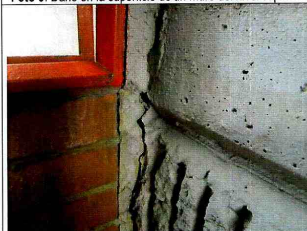
Foto 11. Grieta por separación de la junta del antepecho.
