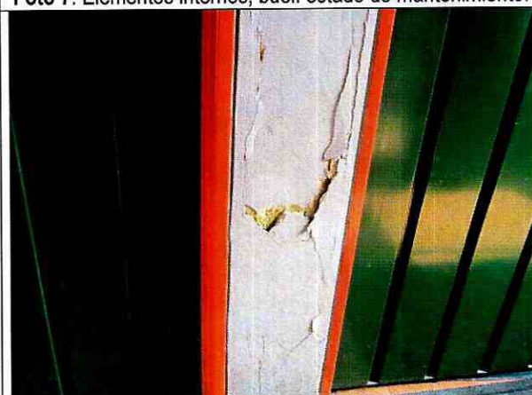
Foto 9. Daño en la superficie de un muro del nivel superior.
