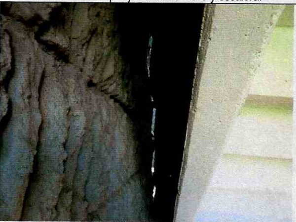
Foto 17. Evidente separación de la junta muro-escalera.
