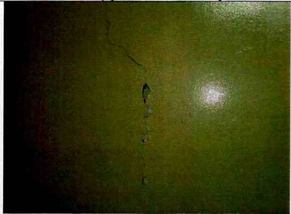
Foto 15. Detalle de la grieta del muro de segundo nivel.
