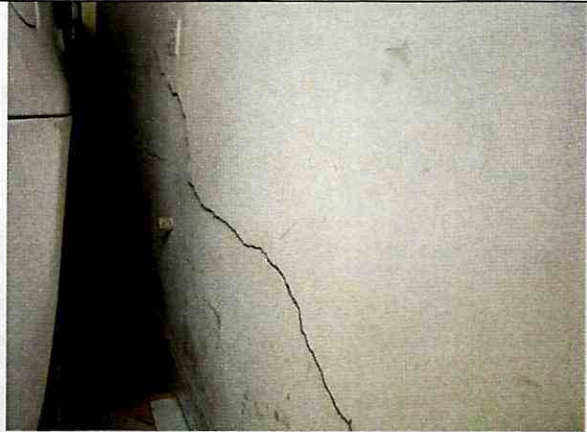
Foto 3. Fractura del muro del costado noroccidental.
