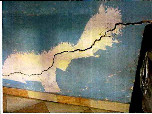
Foto 7. Fractura en muro lateral de la escalera.
