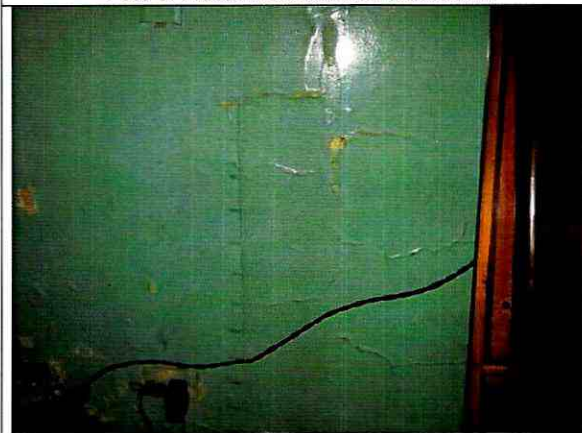
Foto 11. Deterioro de acabados en muros de segundo piso.
