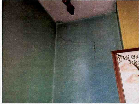
Foto 13. Fisuras y grietas en muros de segundo nivel.
