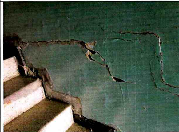
Foto 9. Fractura del muro de la escalera.
