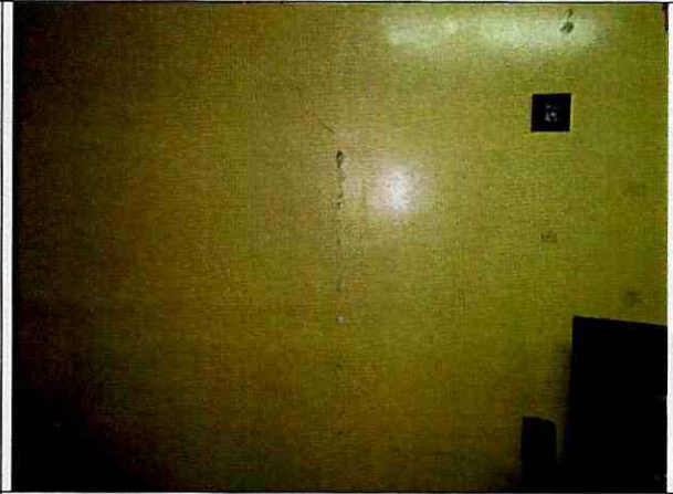
Foto 14. Grieta en muro de segundo piso.
