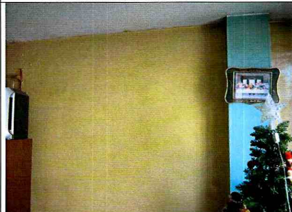
Foto 12. Muros de segundo piso con daño leve.
