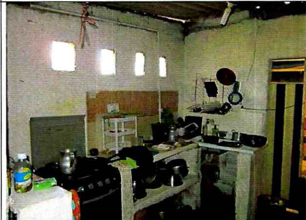
Foto 22. Muros de la cocina en altillo, sin daño visible.
