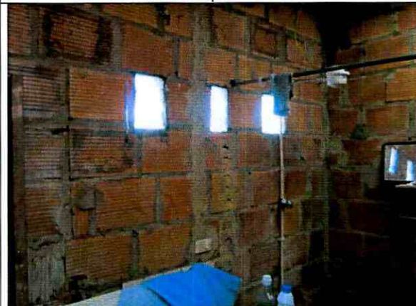
Foto 21. Muros sin acabados en altillo, deterioro incipiente.
