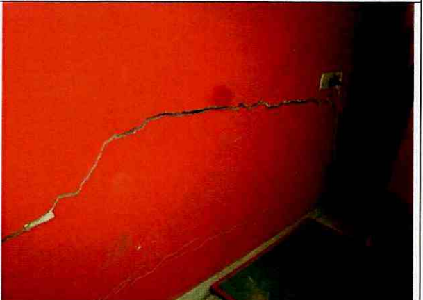
Foto 4. Fractura con varios milímetros de separación.
