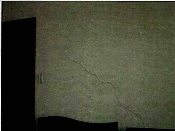
Foto 5. Agrietamiento en diagonal en muro noroccidental
