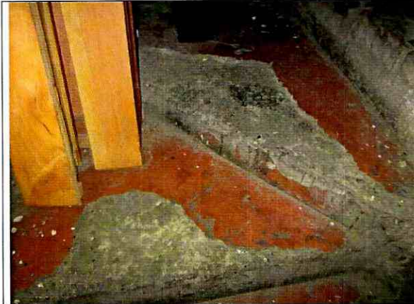
Foto 31. Deterioro de los acabados de la escalera del attillo.
