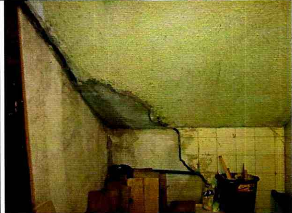
Foto 8. Daños en muros bajo la escalera.
