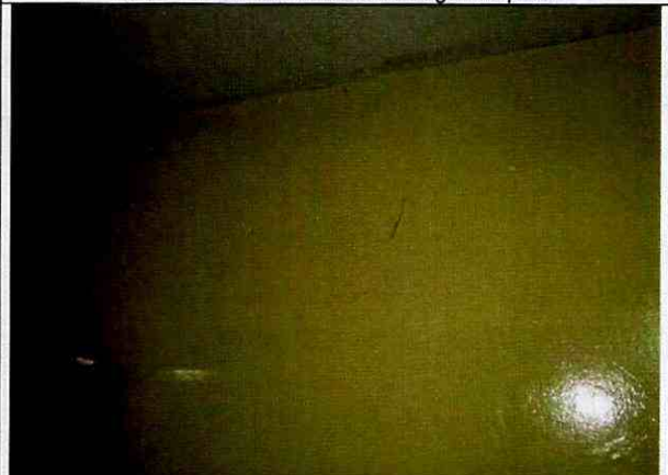
Foto 16. Fisura en muro de segundo piso, daño leve.
