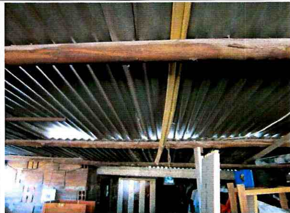
Foto 34. Cubierta liviana buen estado, daño leve.
