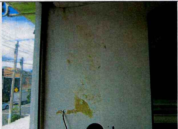
Foto 6. Deterioro superficial de los acabados de muros.
