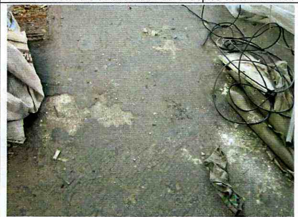
Foto 24. Fisuras de entrepiso de tercer nivel, sin acabados.
