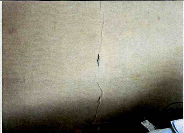
Foto 4. Agrietamiento en superficie de muro del primer piso.
