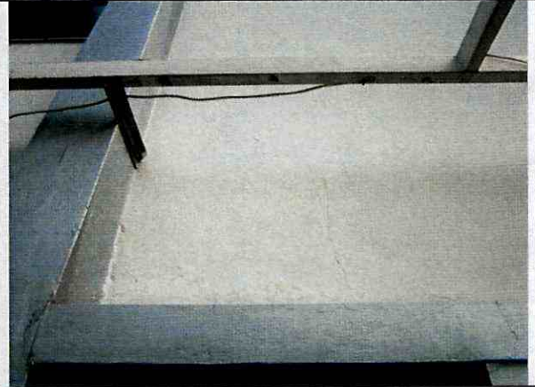
Foto 2. Fisuras en muro de fachada.
