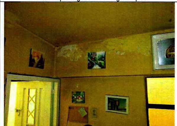
Foto 10. Deterioro de los acabados de muros por humedad.
