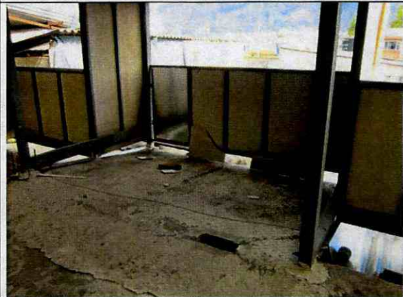
Foto 17. Antepechos de tercer nivel, sin ventanas.
