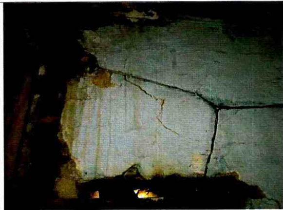
Foto 5. Grietas y deterioro en los muros internos.
