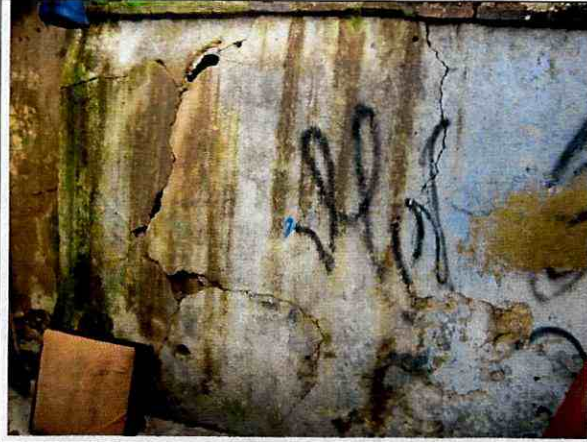
Foto 9. Agrietamientos y desprendimiento del pañete.
