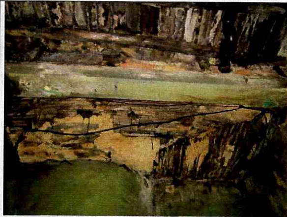
Foto 21. Deterioro generalizado del entrepiso.
