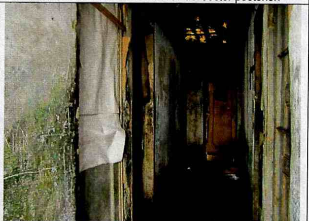
Foto 12. Deterioro de acabados en muros, extremo oriental.
