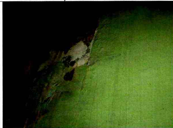
Foto 7. Degradación de los adobes por humedad.
