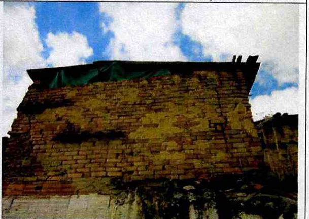
Foto 14. Fracturas en muro de segundo nivel, inestable.
