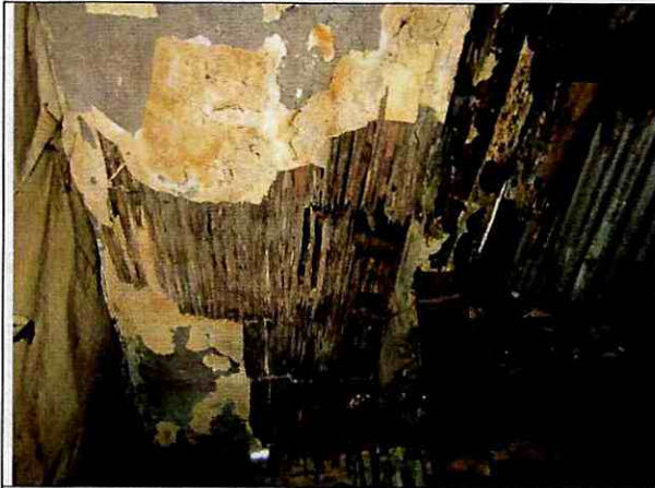
Foto 33. Desprendimiento del pañete del cielo raso.
