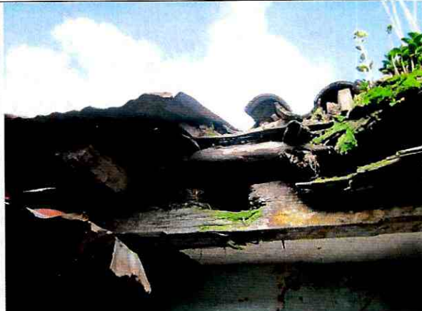
Foto 28. Deterioro y daño de las vigas de madera.
