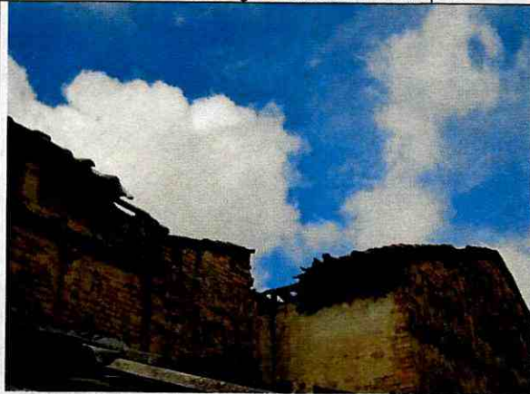
Foto 23. Cubierta del sector frontal, daño severo.
