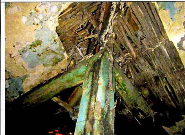
Foto 32. Deterioro generalizado del cielo raso.
