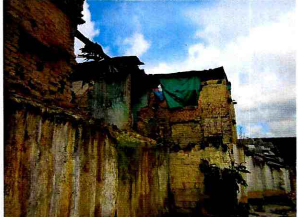
Foto 16. Ligera pérdida de verticalidad de muros.
