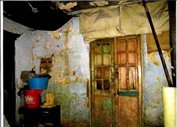
Foto 6. Deterioro generalizado de los muros internos.
