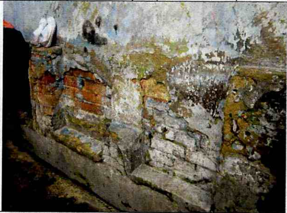
Foto 11. Muros del sector posterior, deterioro por humedad.
