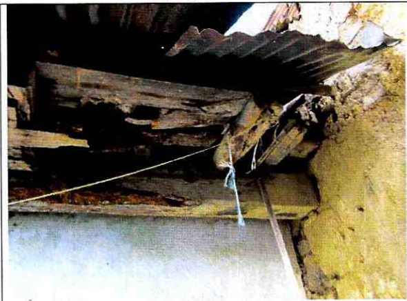
Foto 27. Daño de los elementos de madera de cubierta.
