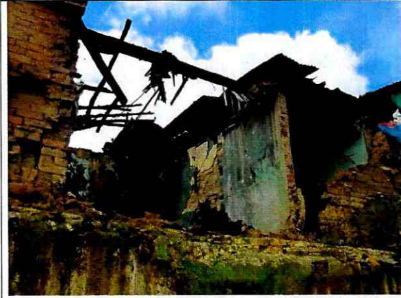
Foto 15. Colapso parcial de muros, falta de soporte lateral.
