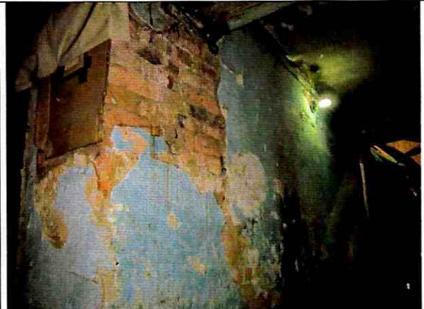
Foto 4. Deterioro de muros, desprendimiento de pañete.
