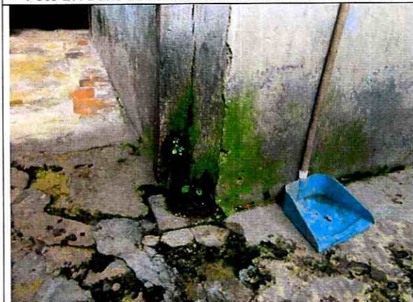
Foto 29. Daño severo de la columna de madera.
