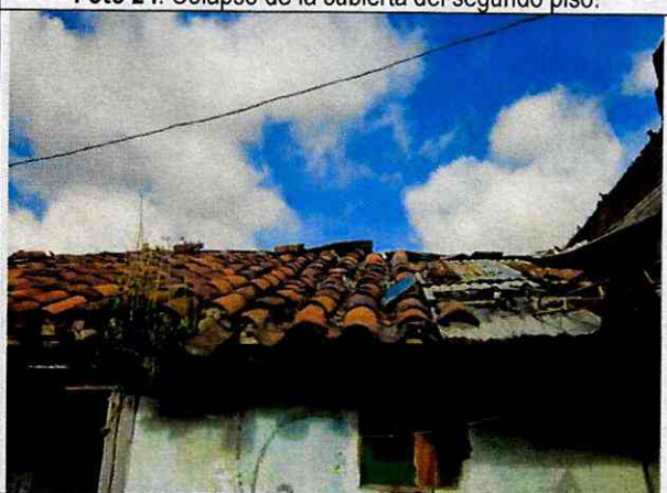
Foto 26. Tejas de barro en mal estado.
