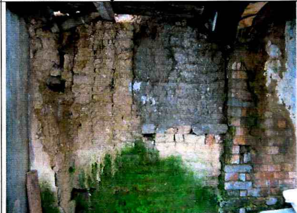
Foto 8. Degradación de los adobes de barro.
