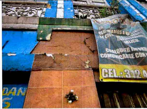
Foto 3. Grietas en muro de fachada.
