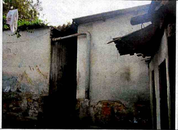
Foto 10. Deterioro de los muros del sector posterior.
