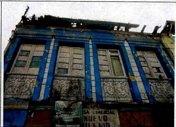
Foto 2. Deterioro de la fachada, colapso de la cubierta.
