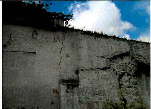
Foto 18. Agrietamiento en muro del extremo oriental.
