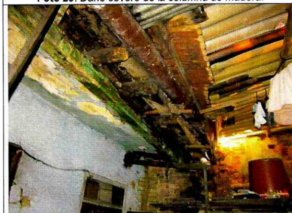
Foto 31. Deterioro y daño generalizado de la cubierta.
