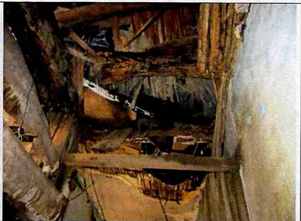
Foto 34. Colapso del cielo raso, deterioro alto.
