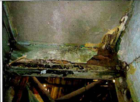
Foto 30. Rotura de elementos de soporte de la cubierta.
