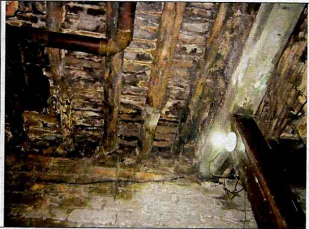
Foto 22. Deterioro y daño de los elementos del entrepiso.
