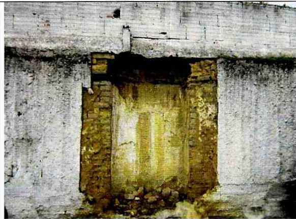
Foto 19. Degradación de los adobes por acción del agua.
