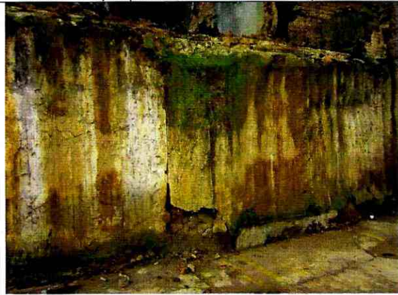
Foto 17. Deterioro fuerte de muros.
