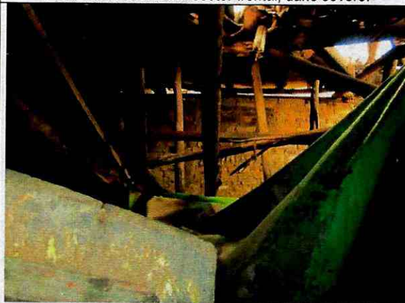
Foto 25. Colapsos parciales de la estructura de cubierta.
