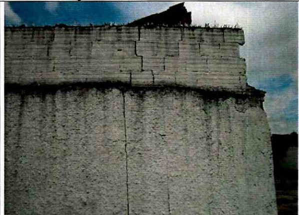
Foto 20. Grieta vertical en muro del sector posterior.
