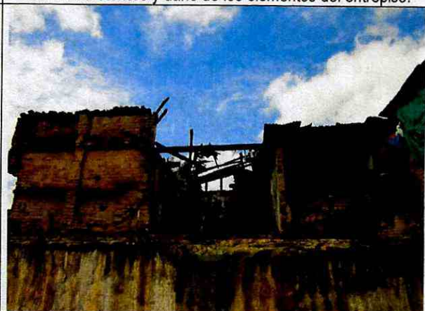
Foto 24. Colapso de la cubierta del segundo piso.
