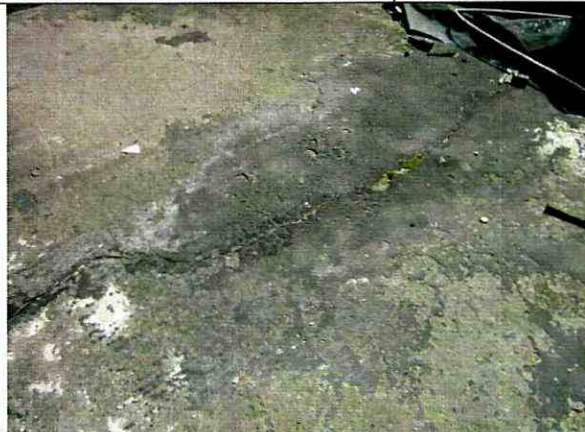
Foto 24. Grieta en la cara superior de la placa de cubierta.
