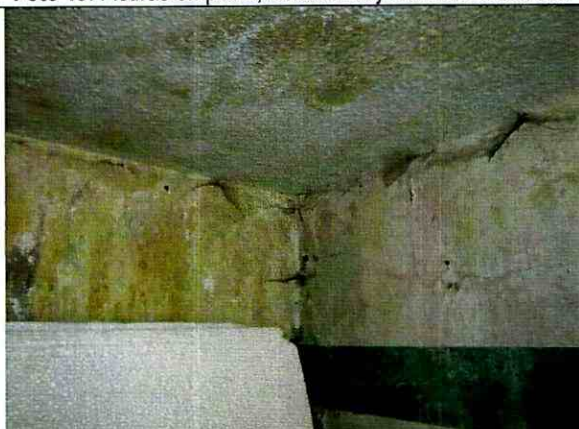
Foto 21. Daño generalizado de los acabados por humedad.
