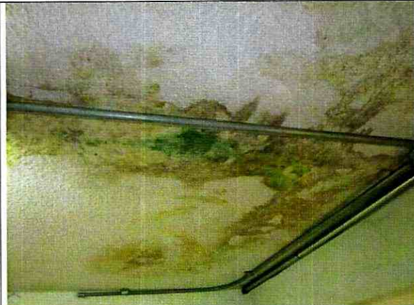
Foto 19. Fisuras en placa, filtraciones y daño de acabados.
