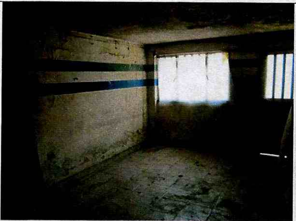
Foto 5. Deterioro y grieta horizontal en muro.
