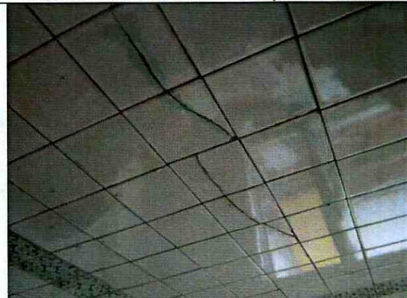
Foto 22. Grieta en cara inferior de la placa de cubierta.
