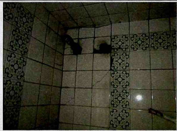
Foto 16. Grietas y daño de los acabados.
