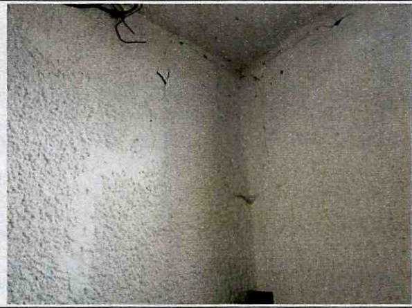
Foto 14. Fisuras en muro del sector posterior.
