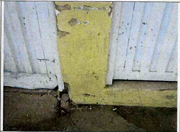
Foto 2. Deterioro y daños en muro de fachada.
