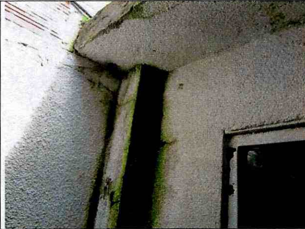
Foto 13. Deterioro de acabados por humedad.
