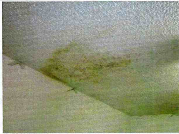
Foto 20. Deterioro del acabado de la placa de cubierta.
