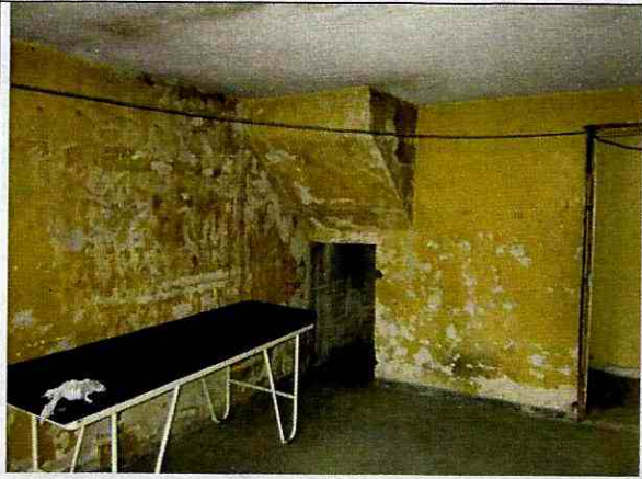
Foto 3. Deterioro de acabados de muros internos.
