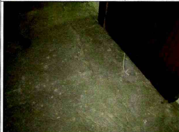
Foto 27. Hundimientos y deformaciones en la placa de piso.
