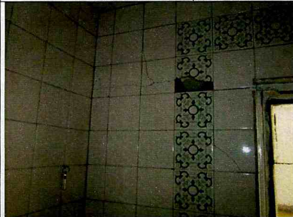
Foto 15. Agrietamientos en muro interno.
