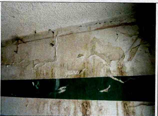
Foto 6. Exceso de humedad, deterioro y fisuras en muro.
