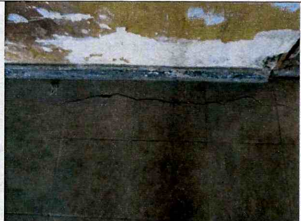
Foto 26. Grieta en la placa de piso.
