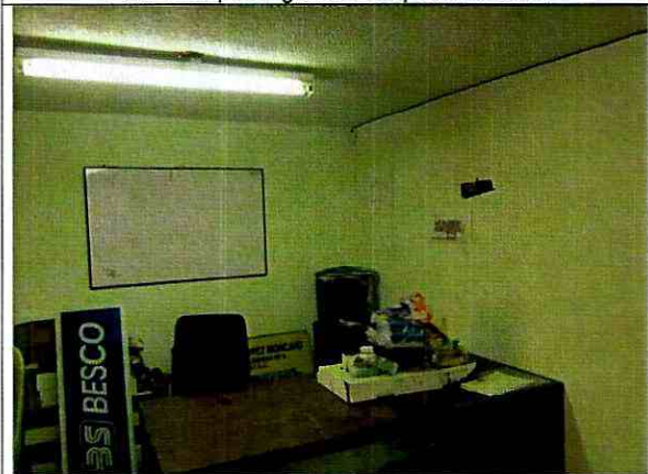
Foto 9. Muros internos con daño leve.
