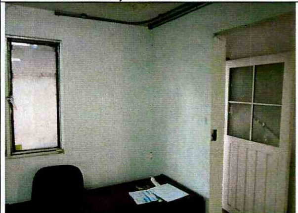
Foto 10. Muros con algunas fisuras.
