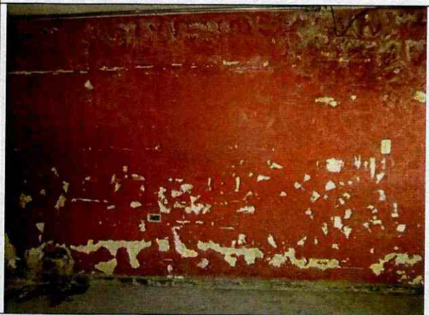
Foto 4. Fisuras y deterioro de acabados de muros.
