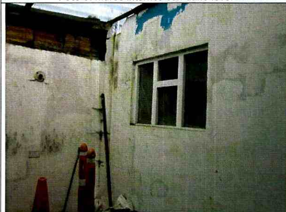
Foto 11. Muros de patio interno, deterioro y algunas grietas.
