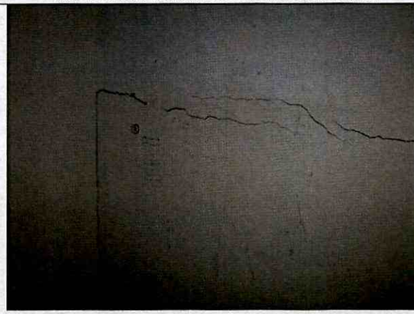
Foto 23. Grieta vertical y horizontal en muro interno.
