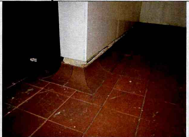
Foto 12. Grieta en la base del muro, deformaciones.
