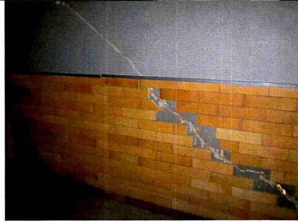
Foto 15. Fractura en muro, varios centímetros de separación.
