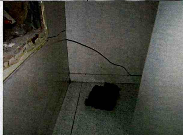
Foto 25. Fractura en parte baja del muro.
