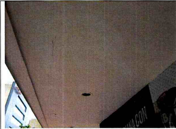
Foto 3. Fisuras en el cielo raso del voladizo.
