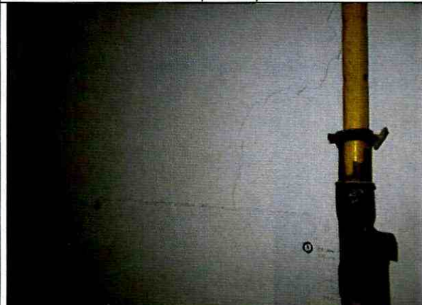
Foto 18. Grietas horizontales y diagonales en muros.
