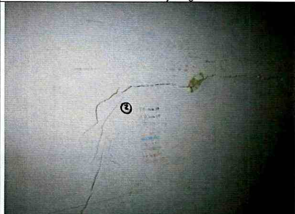
Foto 20. Agrietamiento generalizado de muros internos.
