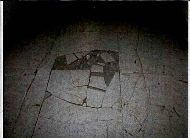
Foto 34. Deformación del piso, deterioro de acabados.
