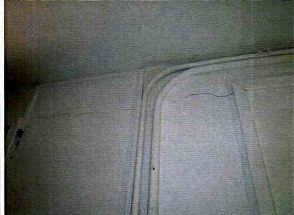
Foto 16. Grieta en parte superior de muro.
