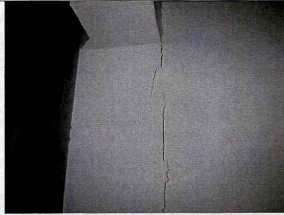
Foto 21. Grieta vertical en muro del sector central.
