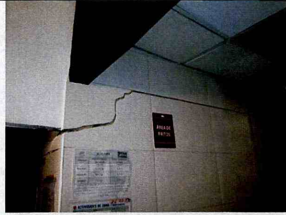
Foto 9. Fractura en muro de la zona oriental.
