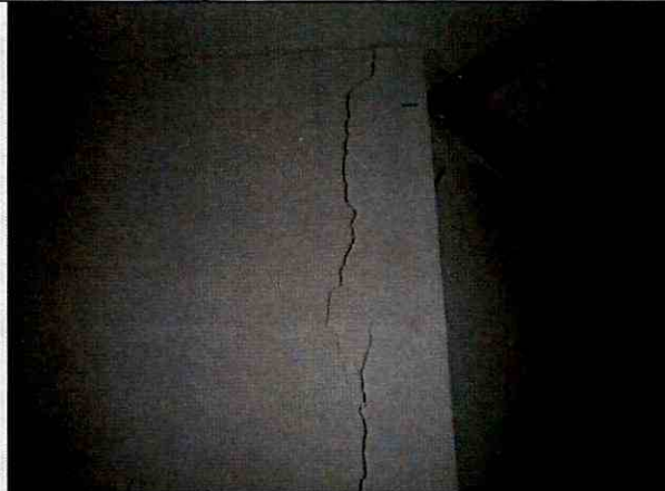
Foto 22. Grieta vertical y separación de la junta entre muros.
