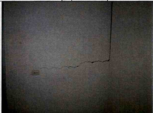
Foto 24. Agrietamientos en la parte media del muro.
