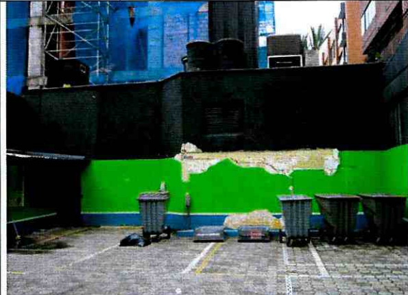
Foto 30. Muros zona externa occidental, daño severo.
