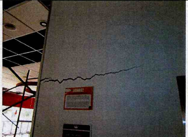
Foto 10. Agrietamiento en muro del sector oriental.
