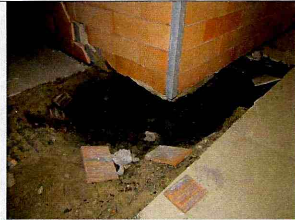
Foto 33. Hundimientos del piso.
