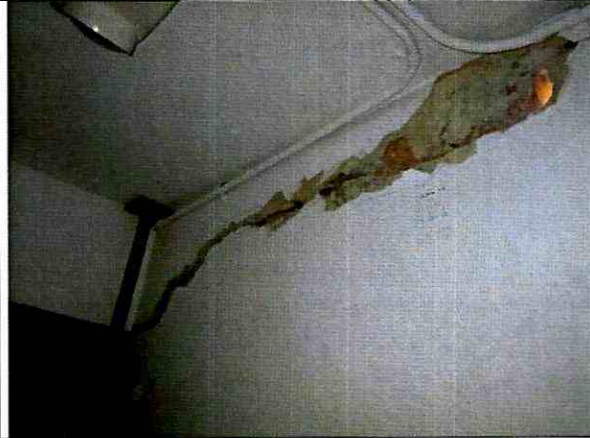
Foto 27. Fractura del muro, daño severo.
