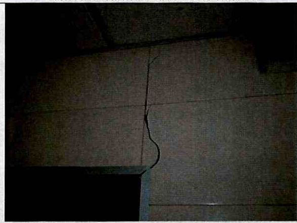
Foto 13. Grieta en dintel de muro del sector oriental.
