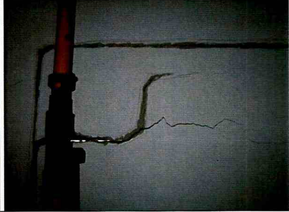
Foto 28. Grieta por separación de la junta entre elementos.
