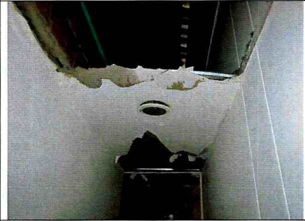
Foto 32. Retiro parcial del cielo raso, filtración de agua lluvia.
