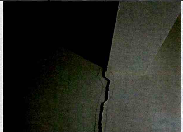
Foto 26. Separación de la junta entre muros.
