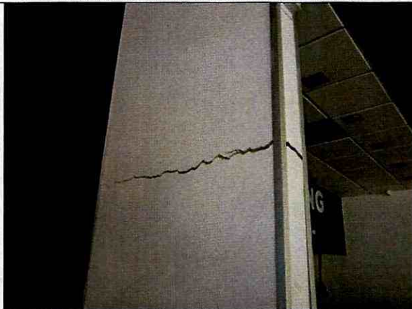
Foto 11. Grieta horizontal en muro divisorio.
