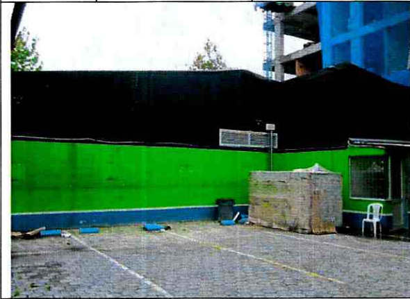
Foto 31. Cubierta, daño leve, algunas filtraciones.
