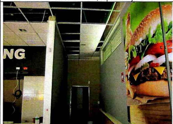
Foto 8. Muro divisorio, retiro parcial de cielo raso.
