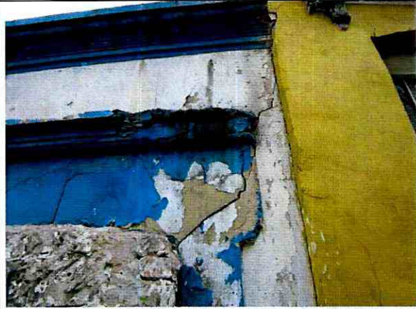
Foto 7. Agrietamiento en el extremo oriental del muro.
