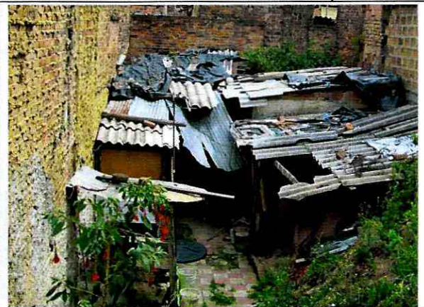
Foto 12. Deterioro alto y progresivo de la construcción.
