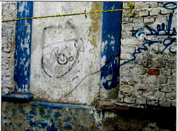
Foto 5. Grietas y deterioro de los acabados.
