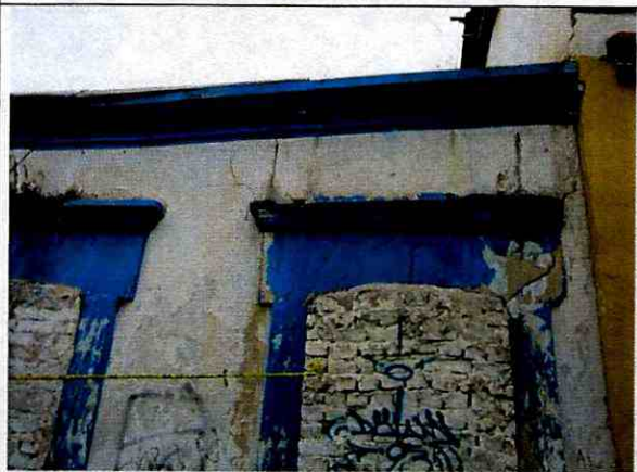
Foto 3. Fisuras y grietas en la parte superior del muro.
