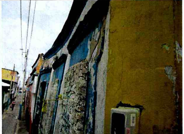
Foto 8. Notoria pérdida de verticalidad, caída hacia el interior.
