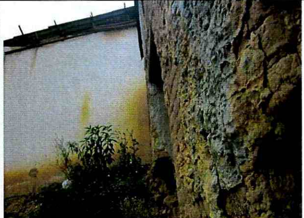
Foto 10. Deterioro alto de los adobes de barro y acabados.
