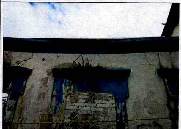
Foto 4. Grietas y deformación del sector central.
