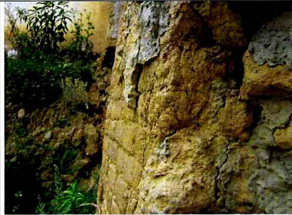
Foto 9. Deterioro de la cara interna del muro.
