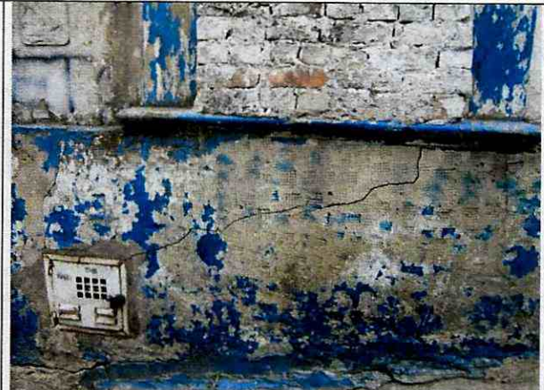
Foto 2. Grietas diagonales en la parte baja de la fachada.
