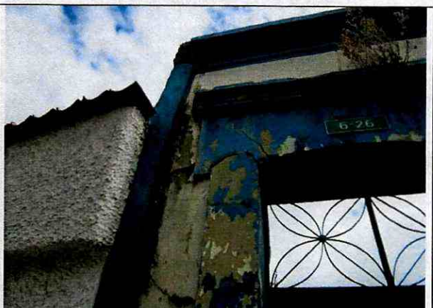
Foto 6. Agrietamiento en el extremo occidental.
