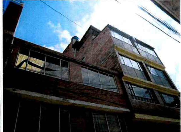
Foto 6. En el muro occidental no se detectan elementos estructurales del sistema de resistencia sísmica.
