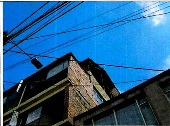
Foto 7. En el muro del costado oriental no se observan elementos estructurales adecuados.
