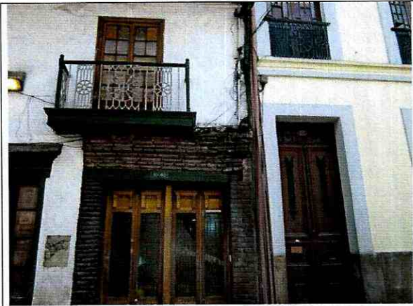
Foto 3. Leve deformación en muro de fachada.
