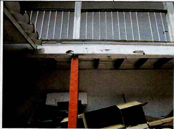
Foto 23. Leves deformaciones de los elementos de madera.
