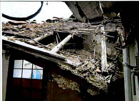
Foto 30. Daño severo, colapso parcial de la cubierta.
