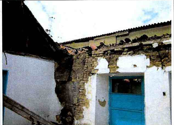
Foto 16. Deterioro y daño severo de muro del segundo piso.
