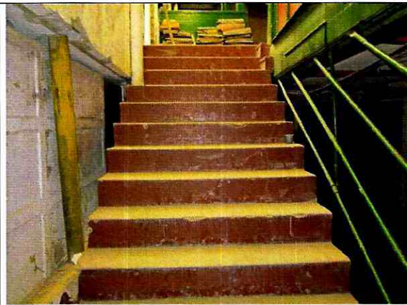
Foto 27. Daño leve de escaleras de concreto.
