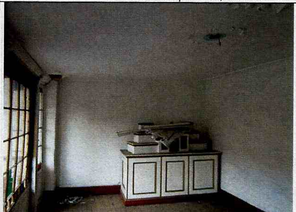
Foto 12. Muro de segundo piso con daño leve.
