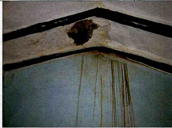
Foto 35. Deterioro fuerte del cielo raso, filtraciones de agua.
