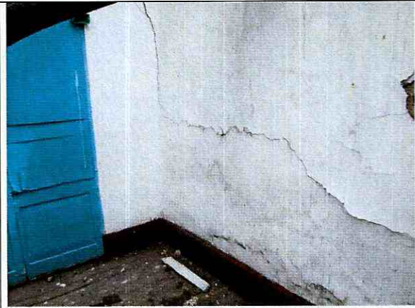
Foto 15. Agrietamiento en muro del segundo nivel.
