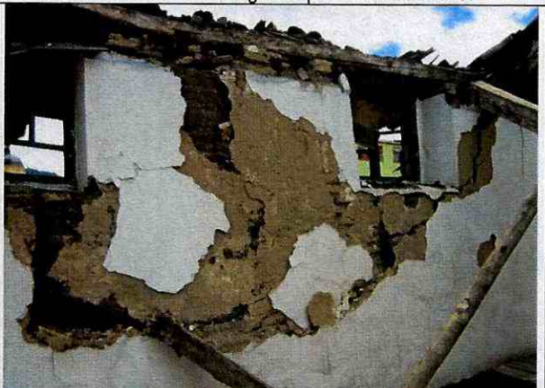
Foto 14. Condiciones de inestabilidad del muro norte.
