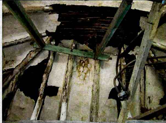
Foto 37. Deformación y desprendimiento del cielo raso.
