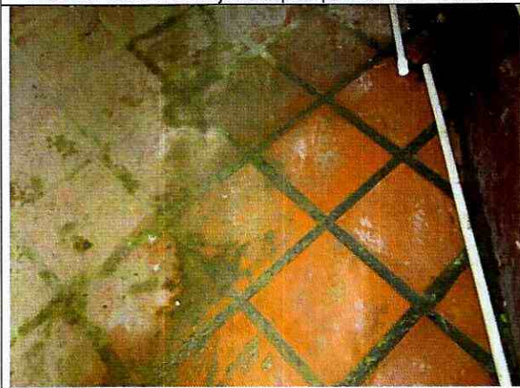
Foto 41. Acabados de la placa de piso, deterioro, sin daño.
