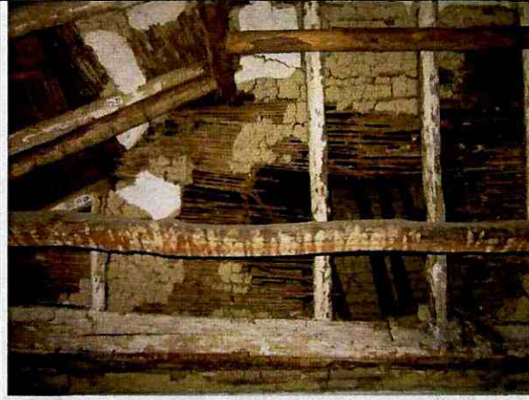
Foto 33. Desprendimientos del cielo raso bajo cubierta.
