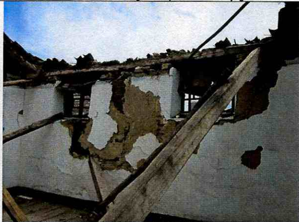
Foto 13. Daño severo del muro de lindero del costado norte.
