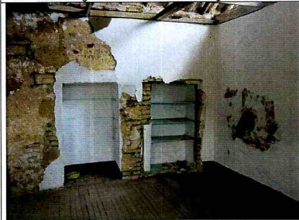
Foto 17. Muros con deterioro alto.
