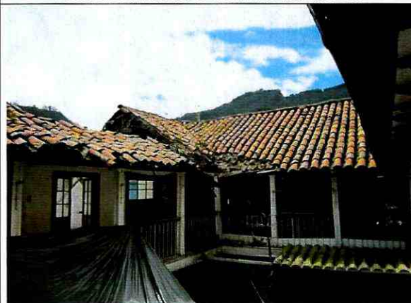
Foto 29. Deformaciones y colapso parcial de la cubierta.
