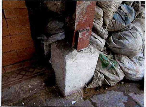
Foto 22. Apoyo de poste de madera, algunas fisuras.
