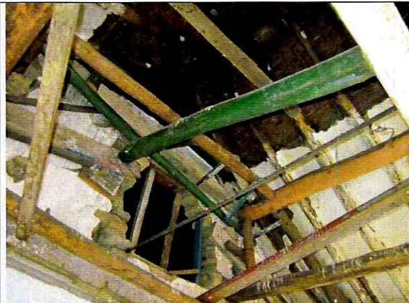
Foto 28. Deterioro de los elementos de cubierta.
