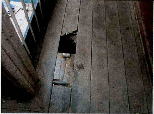
Foto 25. Rotura y desprendimiento de listones de madera.
