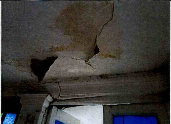
Foto 36. Deterioro progresivo por ingreso de agua lluvia.
