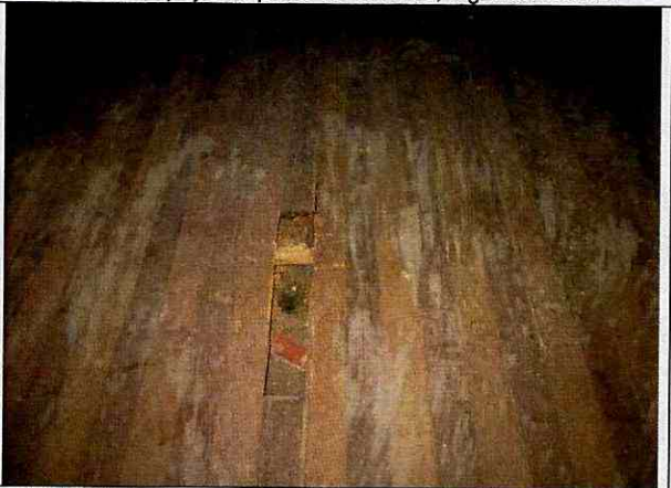
Foto 24. Entrepiso en madera con deterioro y daño leve.
