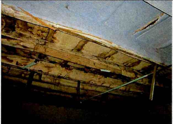
Foto 38. Deterioro de las vigas de madera.
