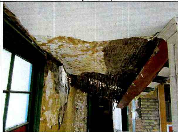
Foto 31. Desprendimiento de la cubierta y el cielo raso.
