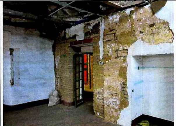
Foto 18. Deterioro de acabados por humedad y Fisuras.
