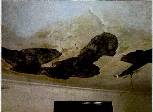
Foto 34. Daño por humedad en el cielo raso.
