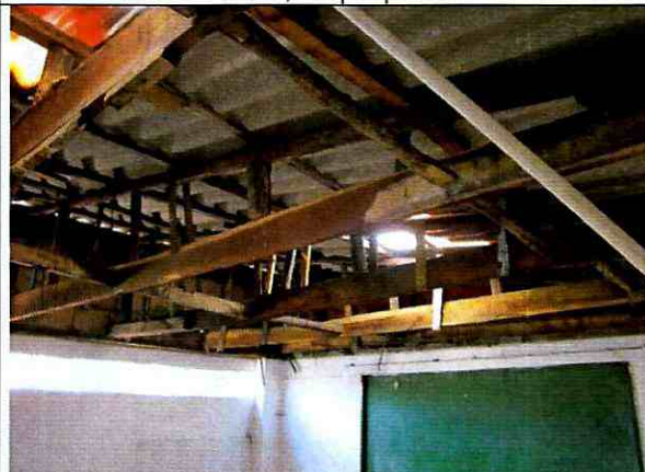
Foto 32. Sector de tejas de fibro cemento, daño leve.
