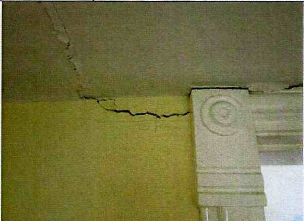
Foto 16. Daño severo en muros, grietas y fracturas.
