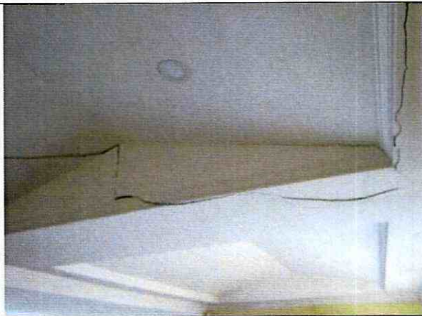
Foto 30. Daño por grietas en el cielo raso.
