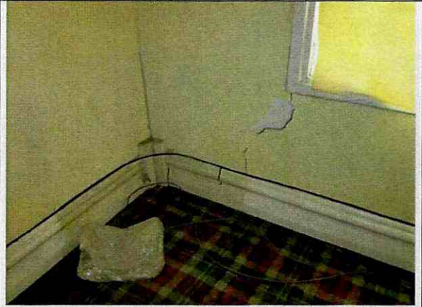
Foto 15. Grietas en muros del primer piso.
