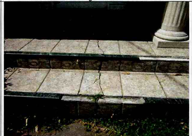
Foto 38. Agrietamiento y deformación de la placa de piso.
