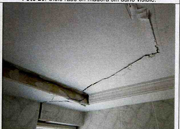
Foto 28. Agrietamiento en cielo raso bajo el entrepiso.
