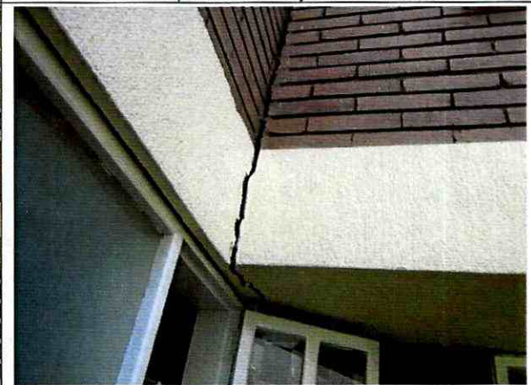
Foto 8. Separación de la junta entre etapas constructivas.
