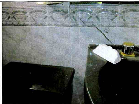
Foto 17. Grietas en muros del baño, daño del acabado.
