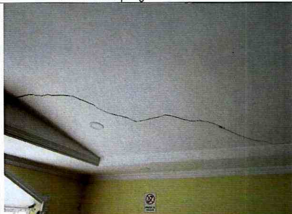
Foto 32. Deformación y grietas en el cielo raso.
