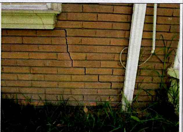
Foto 4. Fisuras y grietas en muros de fachada.
