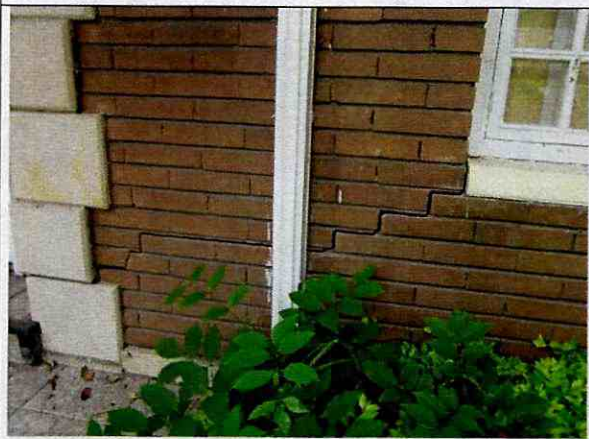
Foto 3. Agrietamiento en muro de la fachada.
