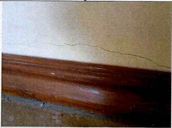
Foto 25. Fisura en la base del muro del altillo.
