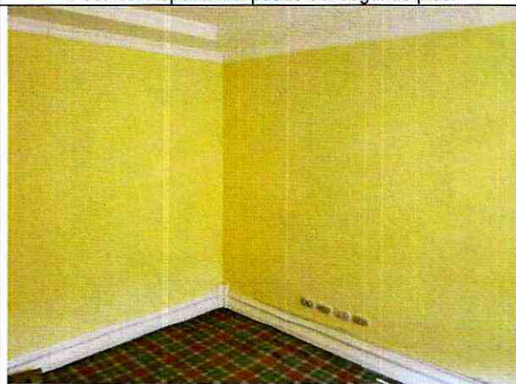
Foto 21. Algunas fisuras en muros de segundo piso.
