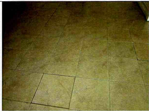
Foto 37. Placa de piso en buen estado, algunas fisuras.
