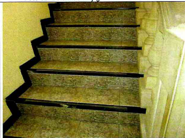
Foto 34. Escaleras en buenas condiciones, algunas fisuras.
