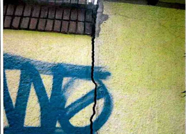
Foto 6. Separación de la junta entre muros.
