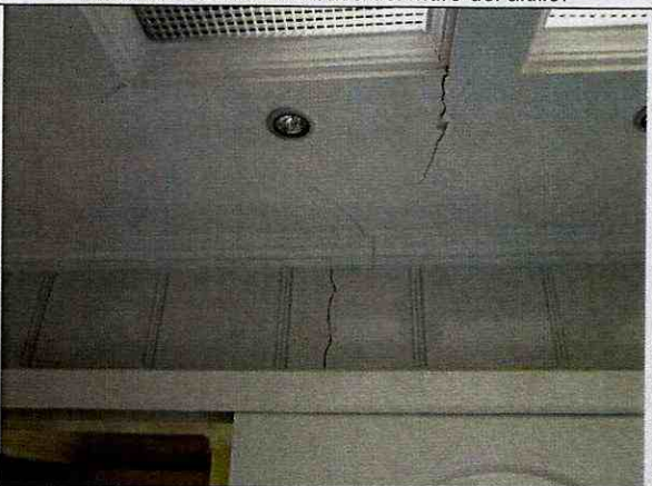
Foto 27. Daño por agrietamiento en dintel y cielo raso.
