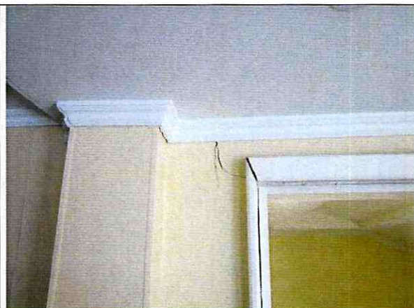
Foto 18. Grieta en dintel del marco de la puerta.
