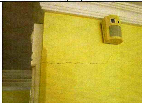
Foto 22. Agrietamiento en muro de segundo piso.
