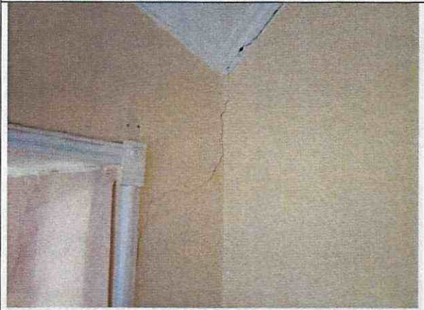
Foto 13. Fisuras y grietas en muros de primer piso.
