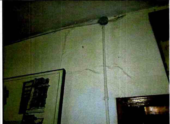
Foto 6. Fisuras en muros de primer piso.
