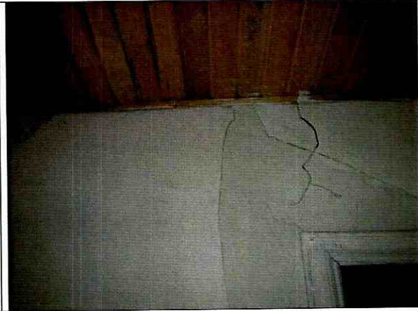
Foto 18. Deterioro de acabados por humedad y Fisuras.
