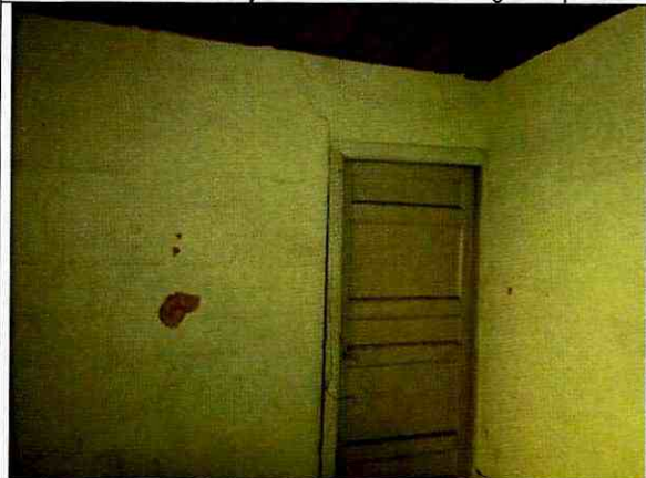
Foto 13. Fisuras y desprendimiento de pañete.
