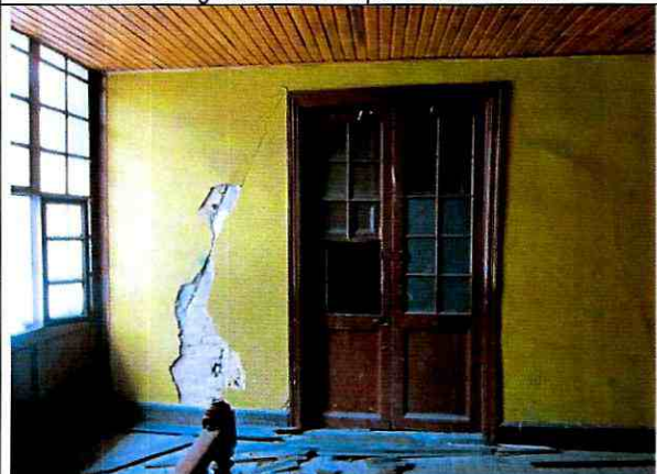
Foto 10. Agrietamientos en muros de segundo piso.
