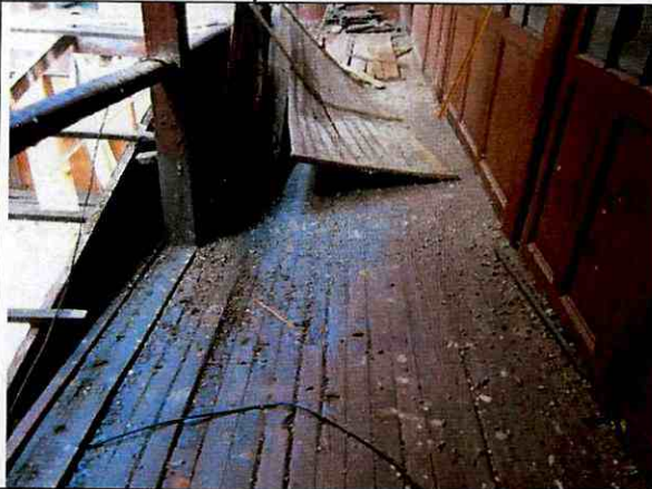
Foto 25. Daño y deterioro de los elementos del entrespiso.
