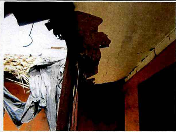
Foto 36. Deformación y desprendimiento del cielo raso.
