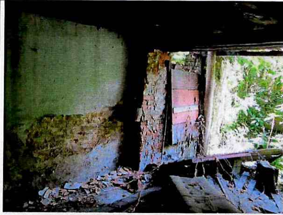
Foto 23. Deterioro y daños en muros del extremo sur.
