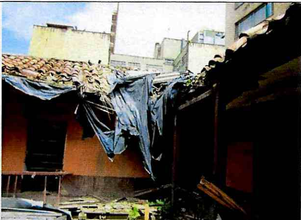
Foto 40. Colapso parcial de la cubierta.
