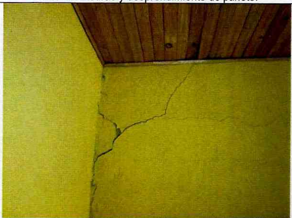
Foto 15. Muros de segundo piso con agrietamientos.
