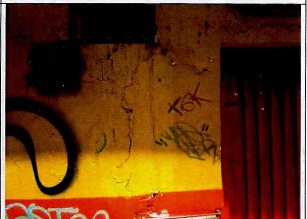
Foto 4. Fisuras y grietas en muros de fachada.
