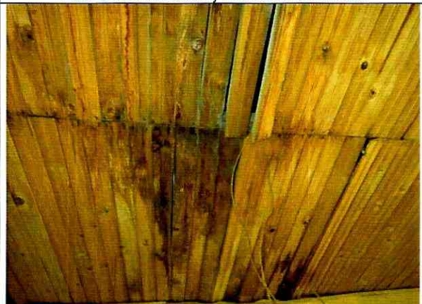
Foto 34. Daño por humedad en el cielo raso.
