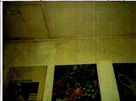
Foto 9. Fisuras en muros internos.
