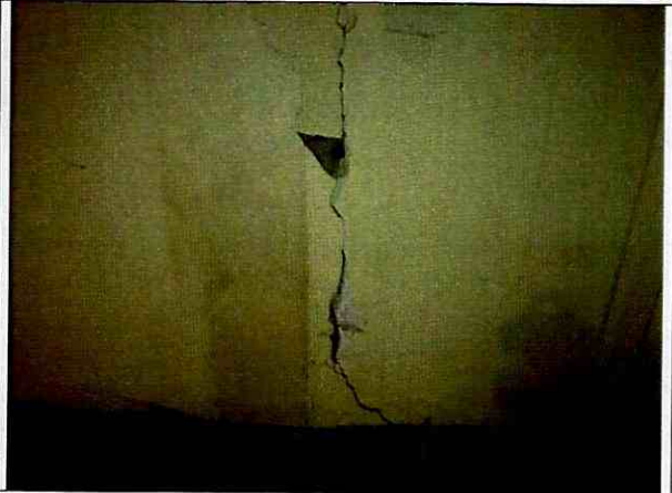
Foto 24. Agrietamiento vertical en muro, daño fuerte.
