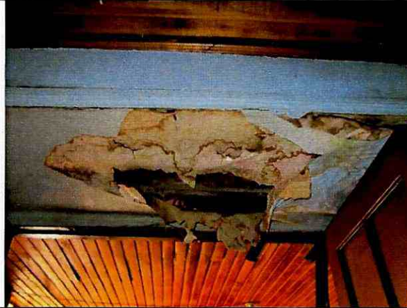
Foto 35. Deterioro fuerte en el cielo raso.
