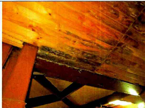
Foto 33. Daños por humedad en cielo raso bajo el entrepiso.
