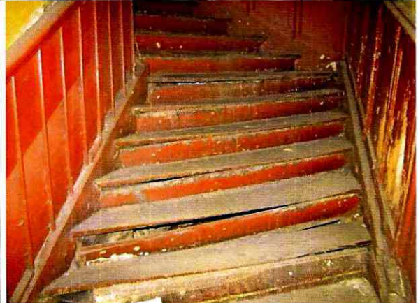
Foto 30. Daño y deterioro de las escaleras.
