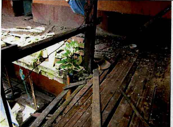
Foto 27. Daño severo del entrespiso.
