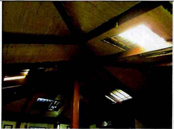
Foto 37. Cielo raso en zona del local comercial.
