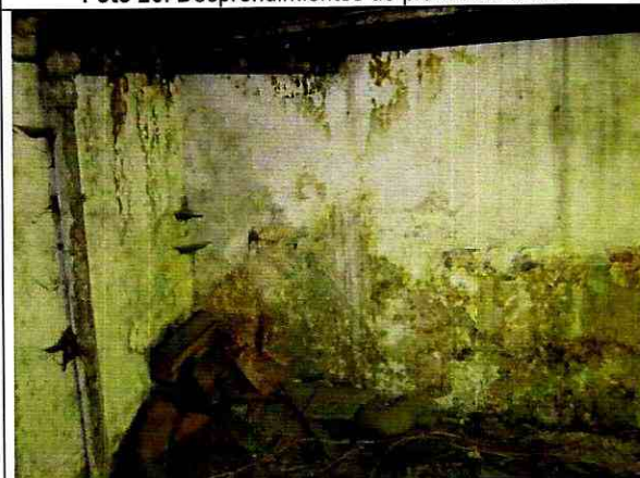
Foto 22. Deterioro de los acabados en muro del extremo sur.
