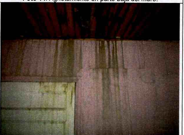
Foto 16. Deterioro de acabados por entrada de agua.
