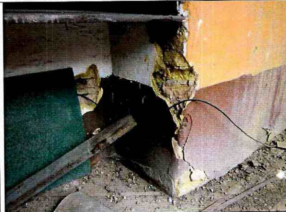
Foto 20. Desprendimientos de piezas de adobe.
