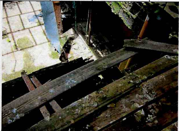
Foto 28. Pérdida de elementos del entrespiso, colapsos.
