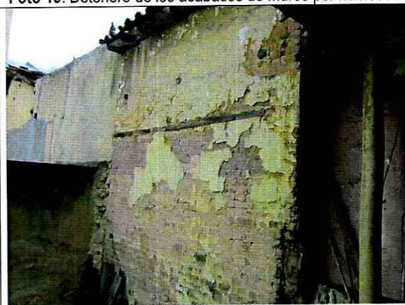
Foto 21. Deterioro fuerte y daños en muro culata.
