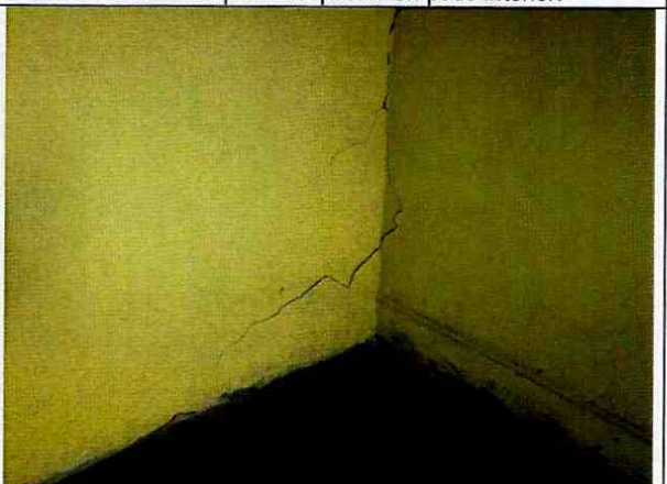
Foto 14. Agrietamiento en parte baja del muro.
