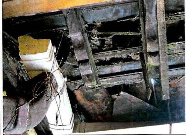
Foto 42. Elementos de soporte de la cubierta en mal estado.
