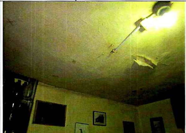
Foto 32. Deformación y fisuras del cielo raso.
