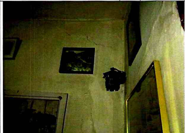
Foto 8. Agrietamiento en parte alta del muro.
