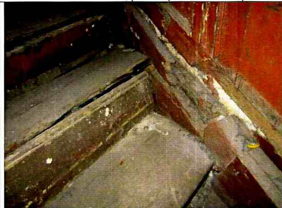
Foto 31. Daño fuerte de los elementos de la escalera.
