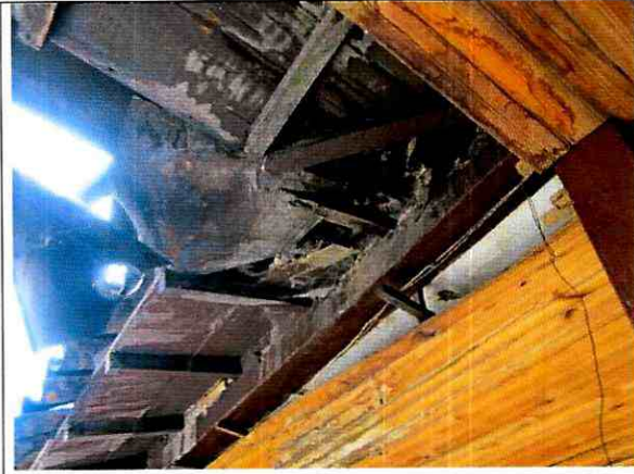
Foto 41. Deterioro fuerte de los elementos de la cubierta.
