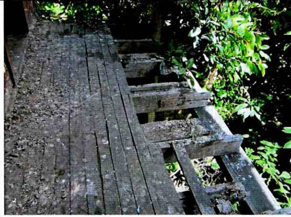
Foto 29. Daño severo, pérdida parcial del entrepiso.
