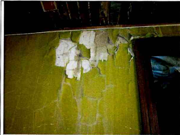
Foto 11. Deterioro y fisuras en muro de segundo piso.
