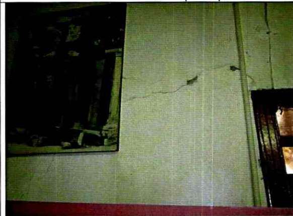
Foto 7. Grietas y fisuras en muros internos de primer piso.
