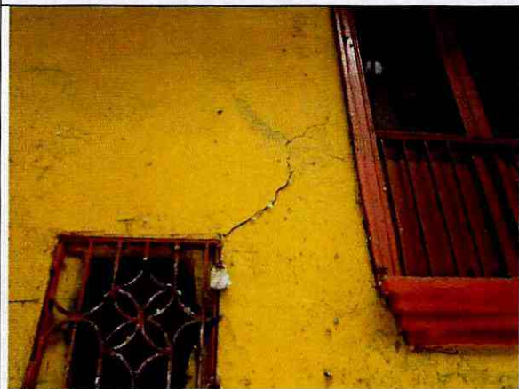
Foto 3. Agrietamiento en muro de la fachada.
