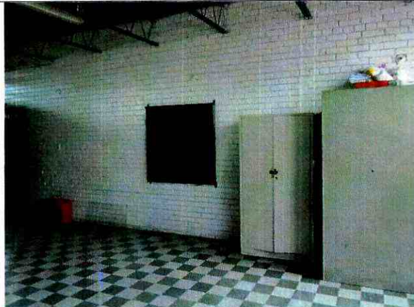
Foto 13. Muro divisorio en el que se presenta fisura vertical.
