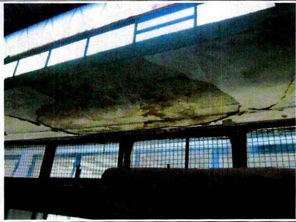
Foto 26. Daño de los acabados por humedad.
