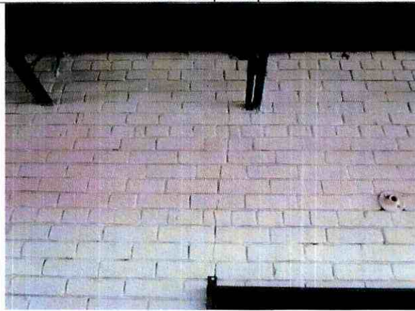
Foto 15. Fisura vertical en muro divisorio.
