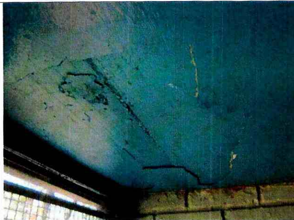
Foto 25. Daños en acabado de plaqueta de concreto.
