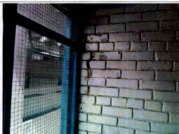
Foto 18. Grieta en muro del sector de anclaje de la ventana.
