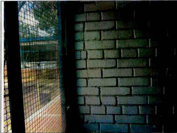
Foto 19. Grieta en el punto de anclaje de la ventana.
