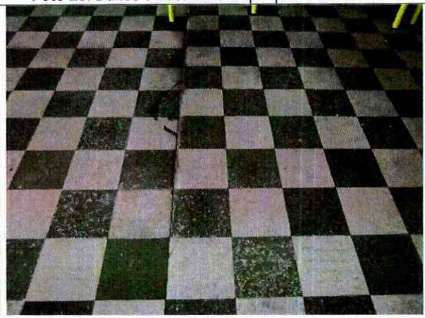
Foto 27. Grietas en piso, junta de construcción de la placa.
