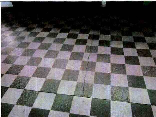
Foto 28. Grieta alineada, juntas entre placas.
