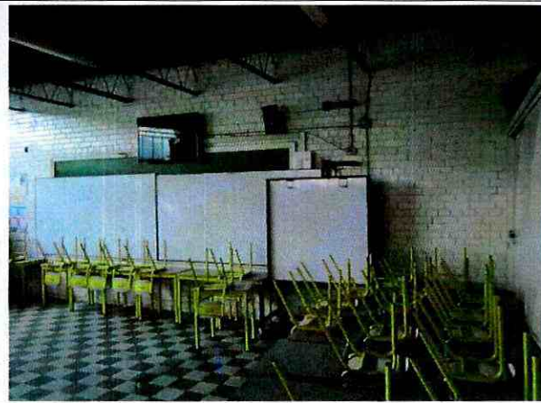
Foto 14. Muros divisorio, se repite la fisura vertical.
