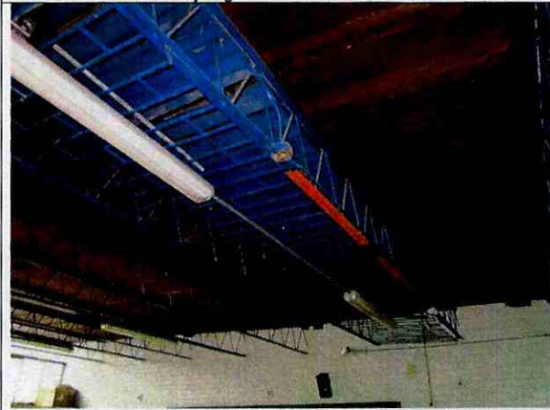
Foto 23. Cielo raso con deterioro moderado por vetustez.
