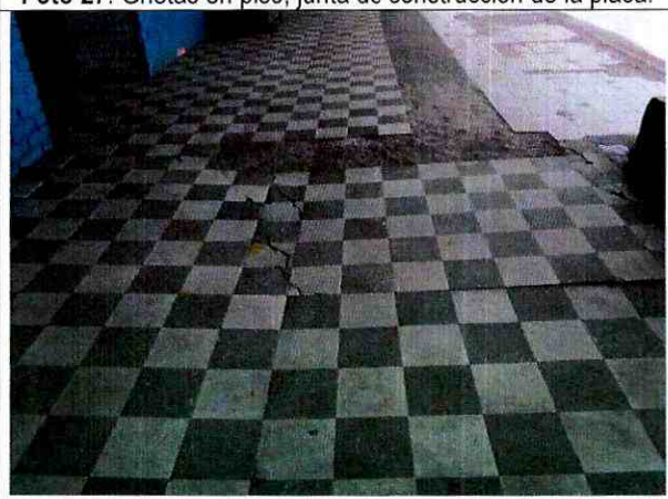
Foto 29. Grietas y modificaciones del acabado del piso.
