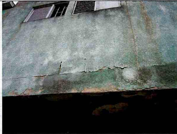
Foto 13. Fisuras y deterioro en muros a nivel del entrepiso.
