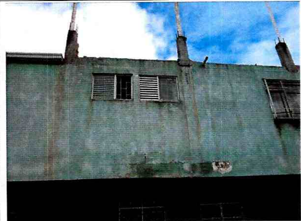
Foto 8. Muros externos con deterioro y daño de acabados.
