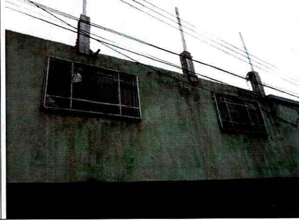
Foto 10. Deterioro por humedad y escurrimientos de agua.
