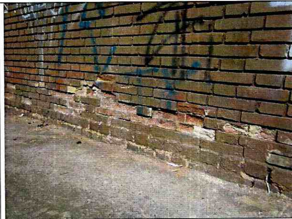
Foto 7. Pérdida de material en piezas de mampostería.
