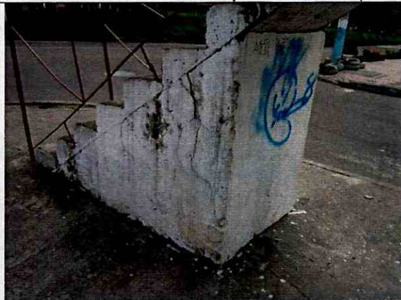
Foto 17. Agrietamientos y deterioro en muros de apoyo.
