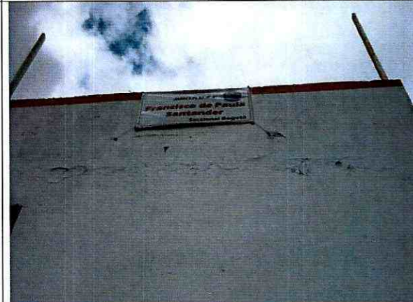
Foto 12. Fisuras y daños en muro del extremo sur.
