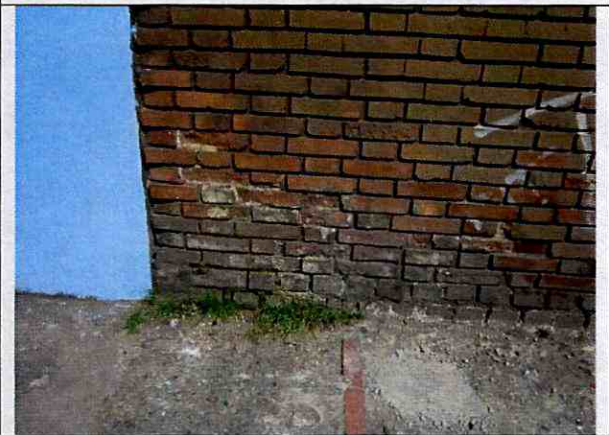
Foto 6. Piezas de mampostería con deterioro.
