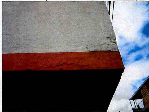
Foto 15. Deterioro de acabados y fisuras en el entrepiso.
