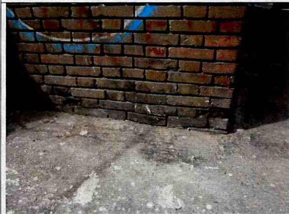
Foto 5. Deterioro de piezas de mampostería de fachada.
