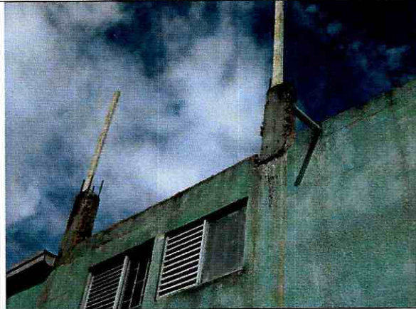
Foto 9. Deterioro de acabados en muro de fachada.
