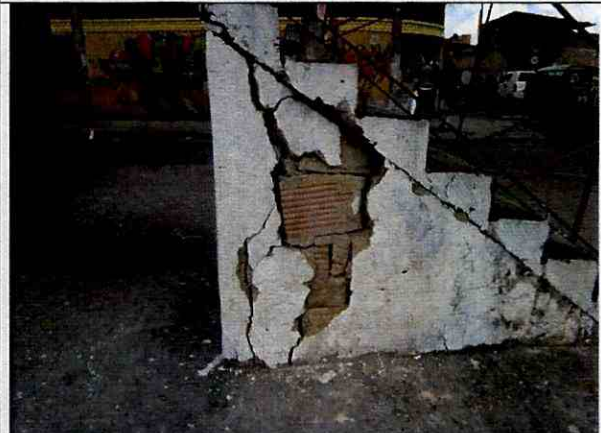
Foto 18. Daño severo del muro de apoyo de las escaleras.
