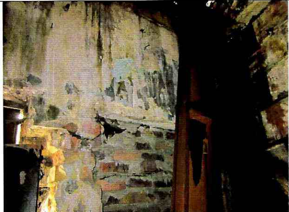
Foto 8. Deterioro fuerte de acabados de muros.
