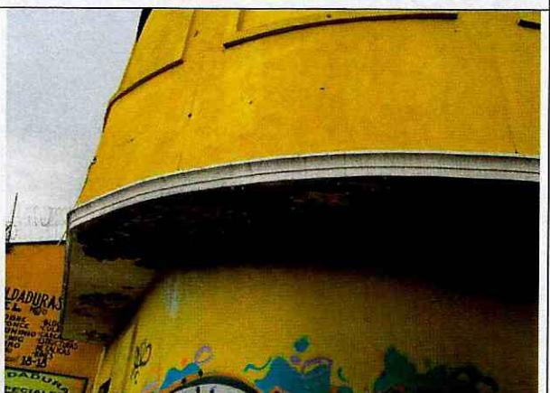
Foto 4. Deterioro fuerte de los acabados del entrepiso.
