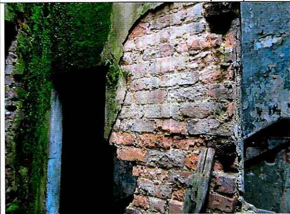
Foto 9. Desprendimiento del pañete y daño de mampostería.
