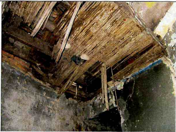
Foto 15. Daño severo de los elementos de entrapiso.
