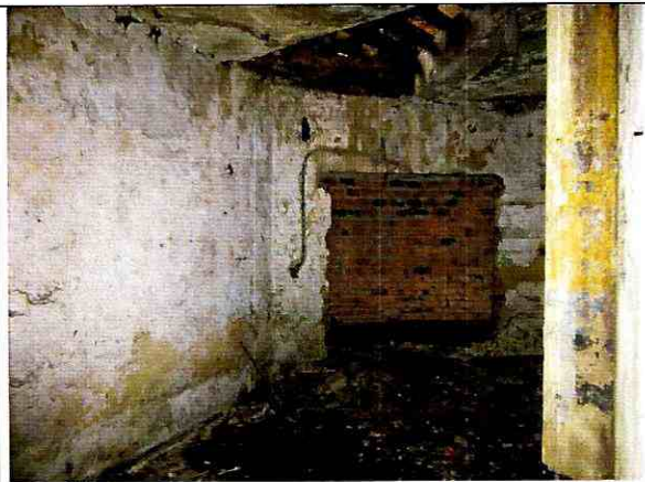
Foto 7. Deterioro de los elementos de primer piso.
