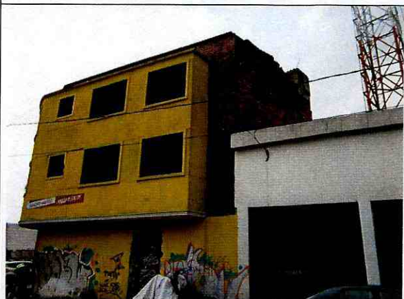
Foto 3. Falta de vidrios en las ventanas.
