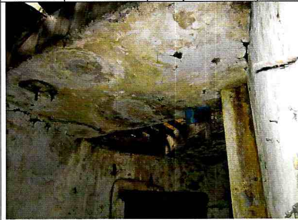
Foto 11. Deterioro de todos los elementos internos.
