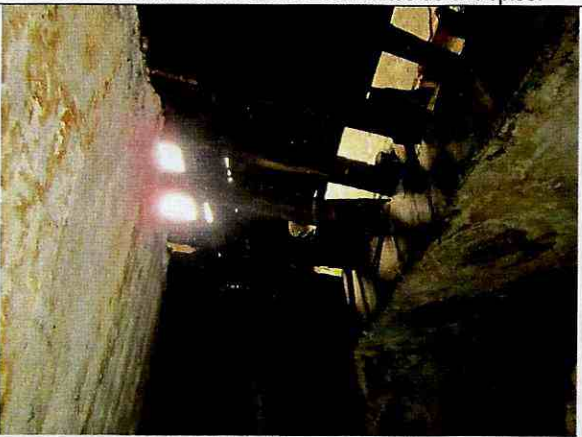
Foto 17. Daños y deterioro de entrapiso en madera.
