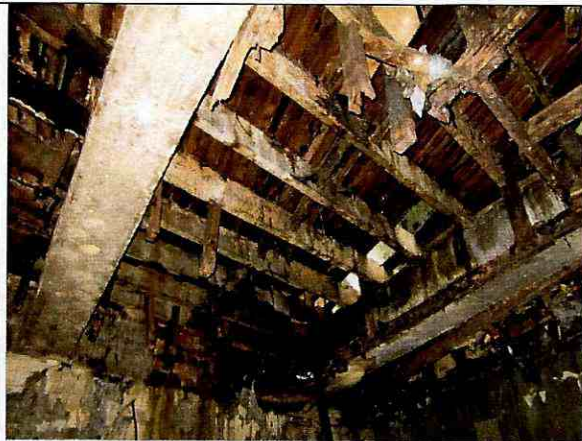
Foto 13. Desprendimiento total del cielo raso.
