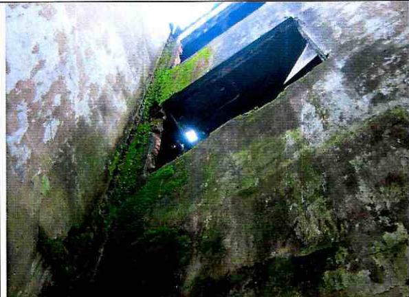
Foto 10. Daño y deterioro fuerte de los muros internos.
