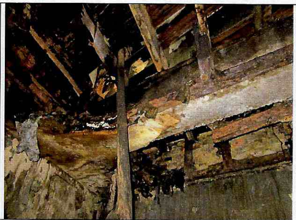
Foto 14. Daño severo y desprendimiento de elementos.
