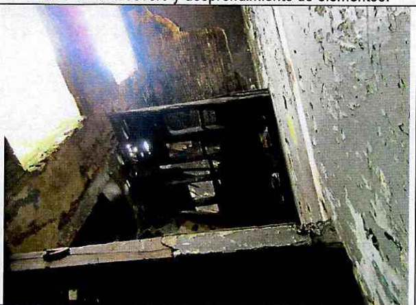
Foto 16. Colapso parcial de los entrapisos.
