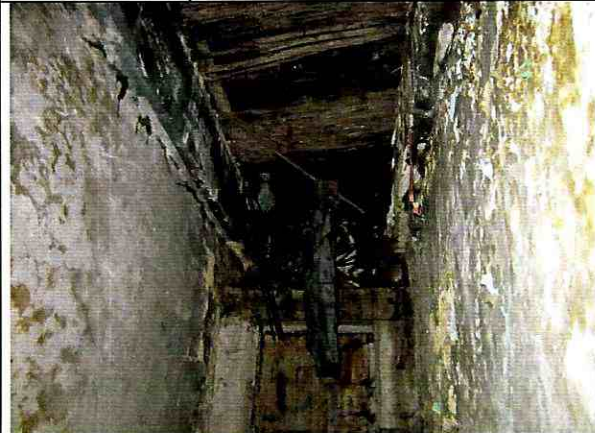
Foto 12. Daño de los muros y del cielo raso bajo entepiso.
