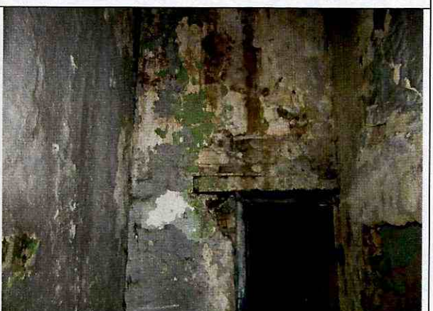
Foto 6. Deterioro fuerte y generalizado de todos los muros.
