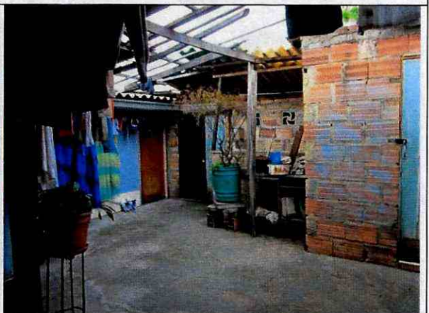
Foto 6. Aspecto del tercer piso, muros sin acabados.
