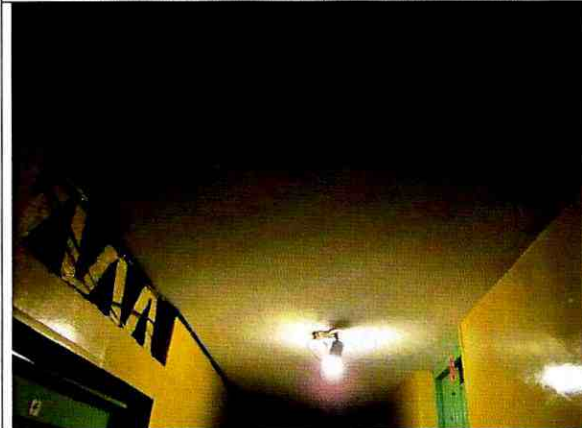
Foto 9. Cara inferior del entepiso del segundo nivel.
