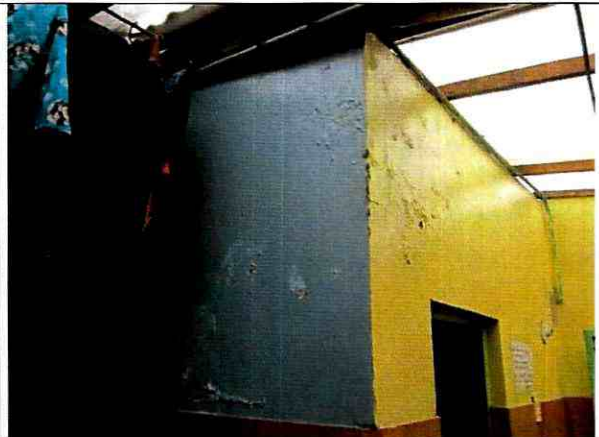
Foto 8. Muro del tercer piso afectado por humedad.
