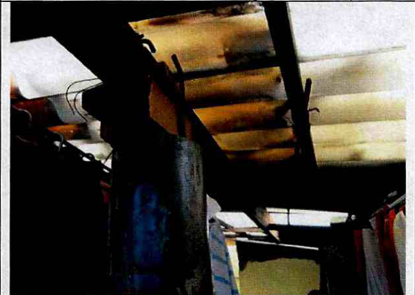
Foto 16. Tipo de apoyo deficiente de la cubierta.
