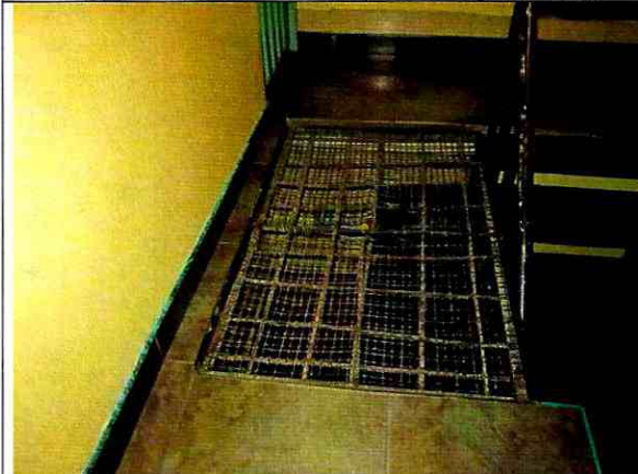
Foto 11. Rejilla metálica con deterioro por uso.
