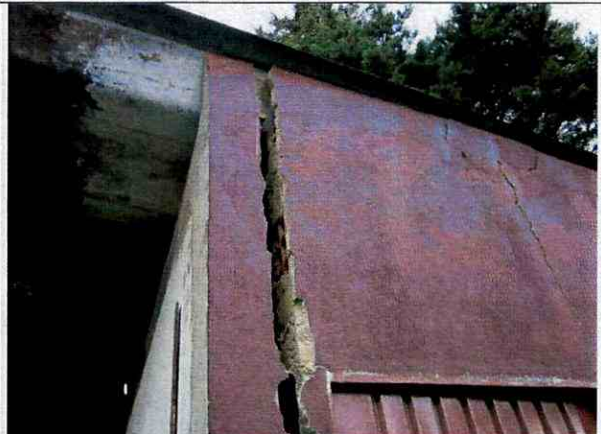
Foto 6. Daño severo y fractura en muro de fachada.
