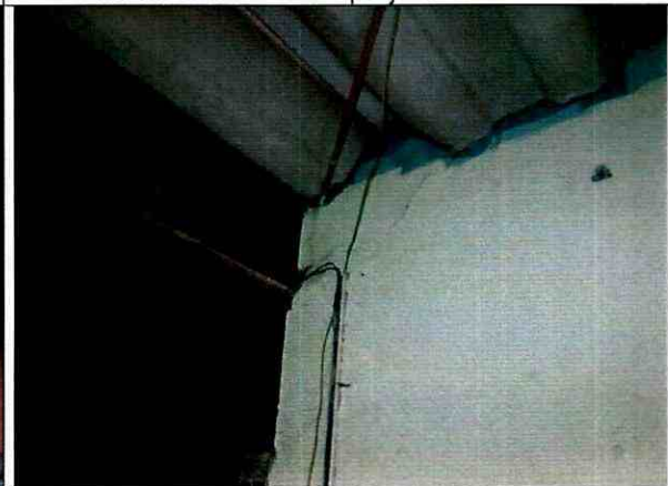
Foto 14. Grietas en la parte superior de los muros.
