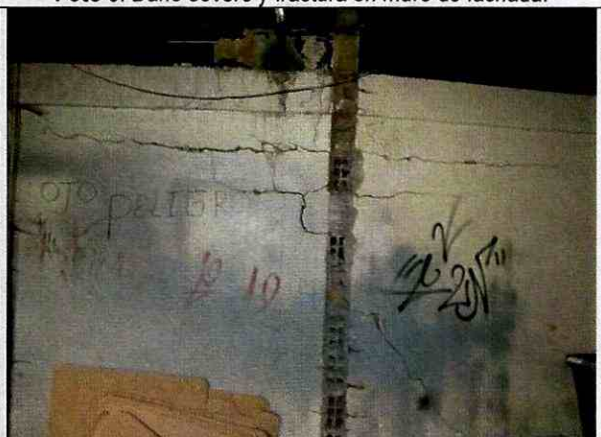
Foto 8. Grietas en muros internos, daño severo.
