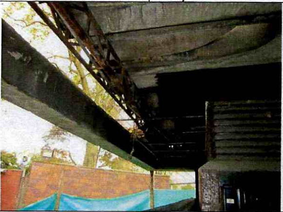
Foto 19. Deterioro de elementos metálicos de cubierta.
