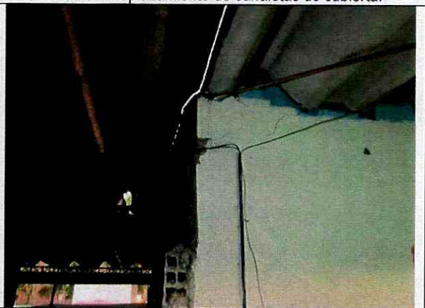
Foto 20. Canaletas de cubierta en mal estado.
