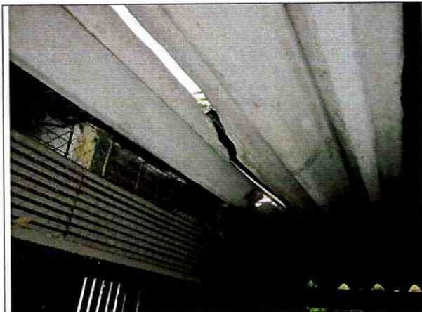
Foto 21. Fractura de canaleta de cubierta.
