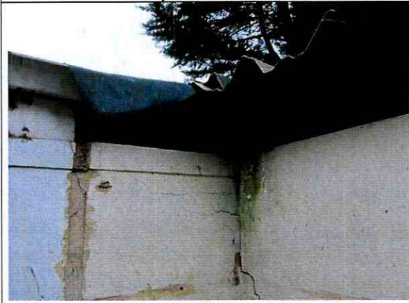
Foto 11. Grietas y deterioro en muro interno sin protección.
