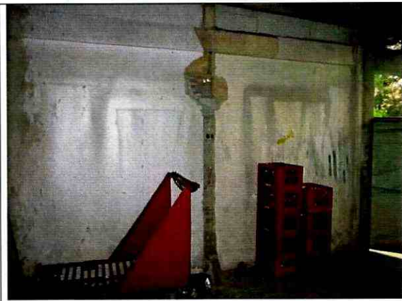
Foto 9. Daños y deterioro en muros internos.
