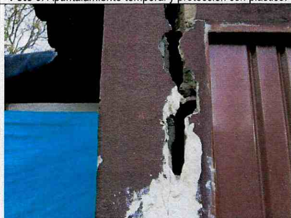
Foto 7. Fractura con varios centímetros de separación.
