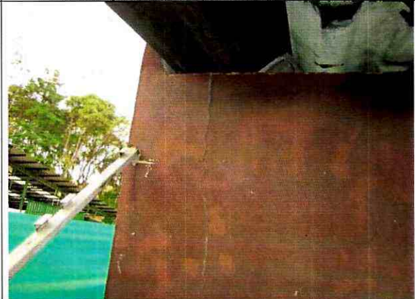
Foto 12. Grietas en muro por junta con estructura.
