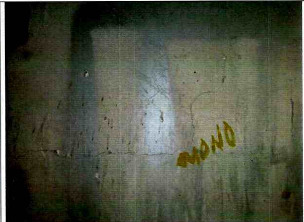
Foto 10. Agrietamientos y fisuras en muros internos.
