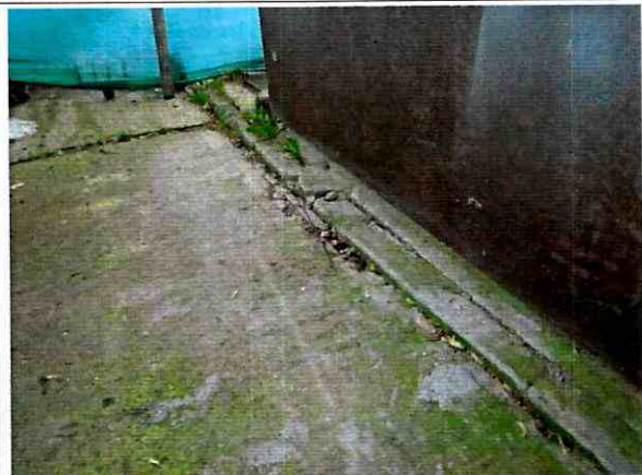
Foto 22. Deformaciones y hundimientos del piso.
