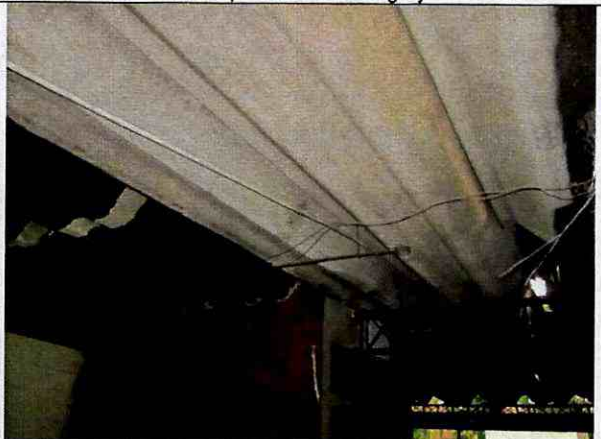
Foto 18. Desplazamiento de canaletas de cubierta.
