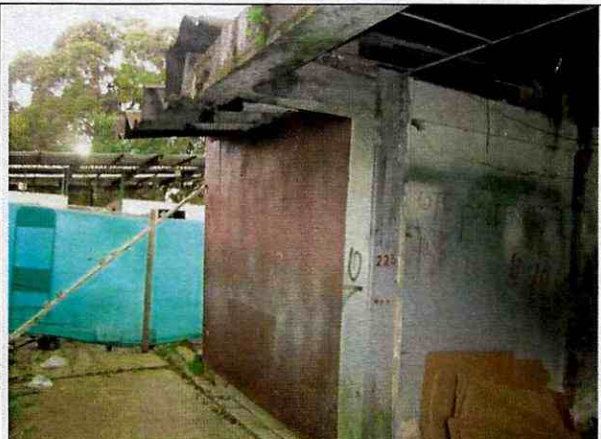
Foto 4. Deterioro y fisuras en muros perimetrales de fachada.
