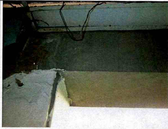
Foto 15. Fisuras en columna y viga.
