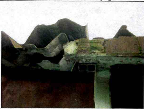
Foto 17. Demolición parcial y deterioro.
