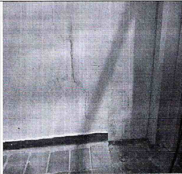
Foto 9. Fisuras en la base del muro del predio vecino.
