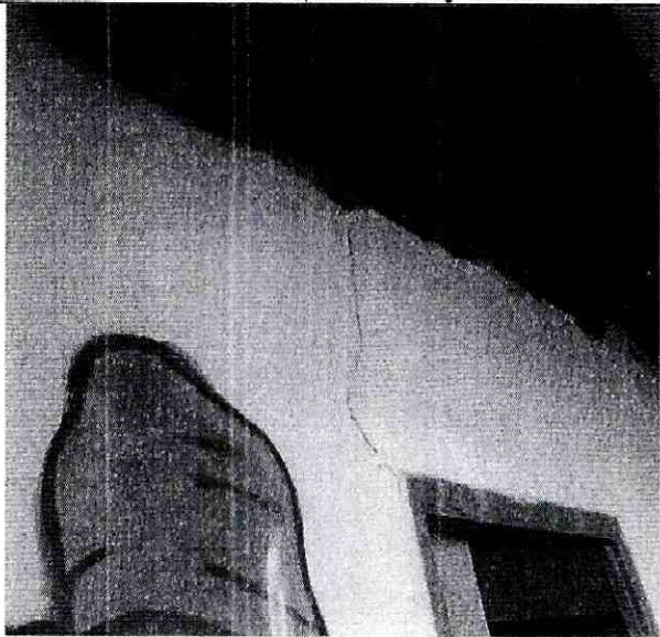
Foto 15. Grieta en parte alta del muro, segundo nivel.
