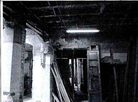
Foto 9. Muros de primer piso con deterioro de acabados.
