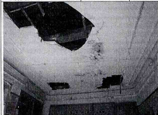
Foto 41. Deterioro del cielo raso bajo cubierta.
