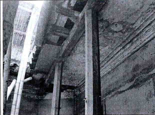
Foto 31. Deterioro generalizado por humedad y otros.
