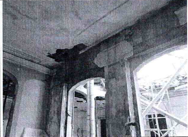
Foto 20. Deterioro fuerte de los acabados.
