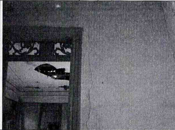
Foto 17. Agrietamientos en muros de segundo piso.
