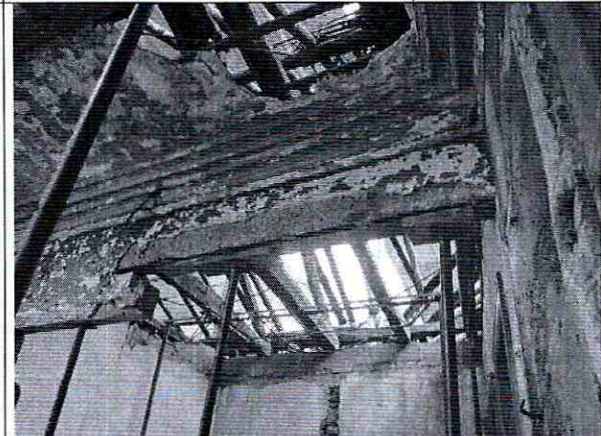
Foto 36. Colapsos parciales de elementos de cubierta.
