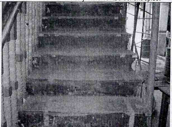
Foto 28. Escaleras en madera con daño moderado
