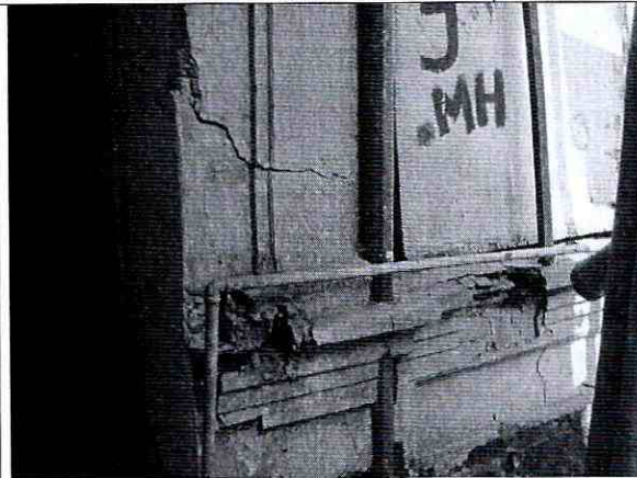
Foto 21. Fractura del muro, dislocación de mampostería.
