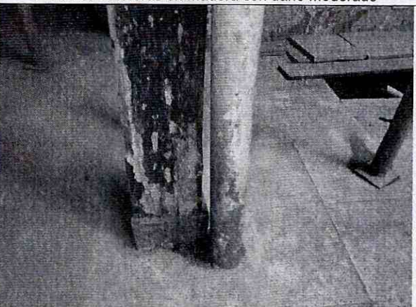
Foto 30. Deterioro de los postes de madera de soporte.
