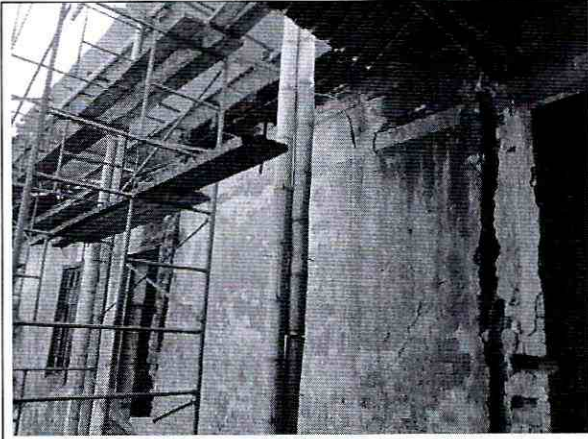
Foto 19. Deterioro de los acabados de muros por humedad.
