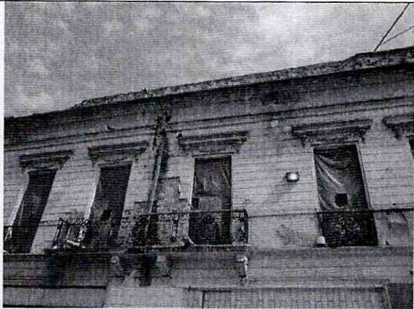
Foto 3. Deterioro de los elementos de la fachada.
