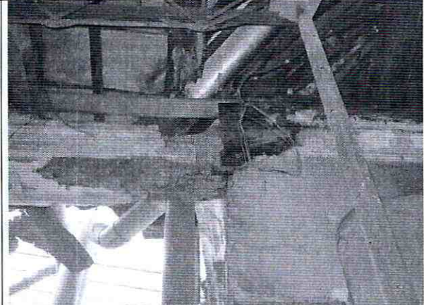
Foto 34. Daño severo en elementos de soporte de la cubierta.
