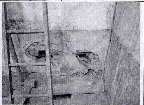
Foto 18. Daño fuerte, desprendimientos de mampostería.
