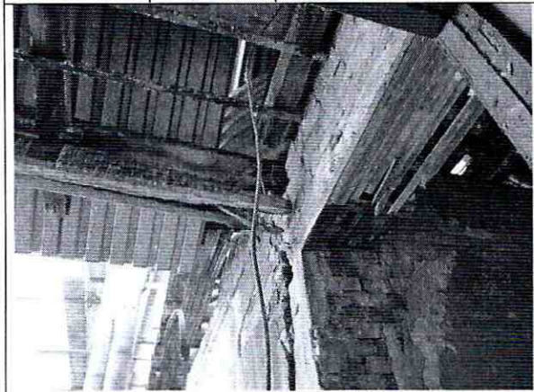
Foto 35. Vigas de madera deterioradas y fracturadas.
